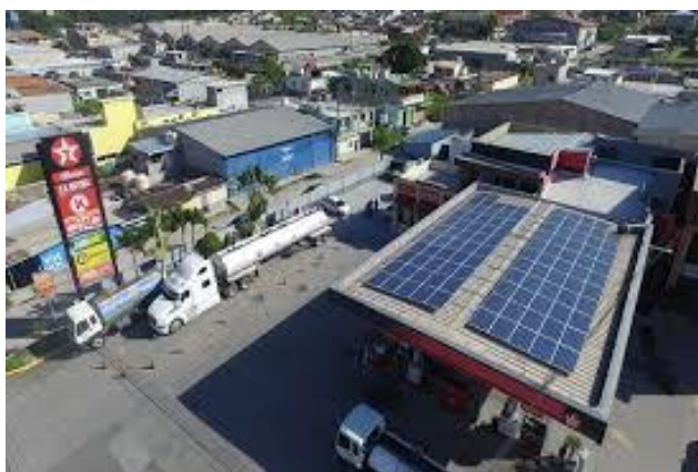
Ilustración 13 - Sistema FV sobre techo gasolinera Texaco "La Reyna".
