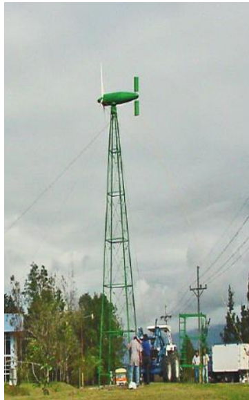
Ilustración 7: Pequeño aerogenerador instalado en el TEC
