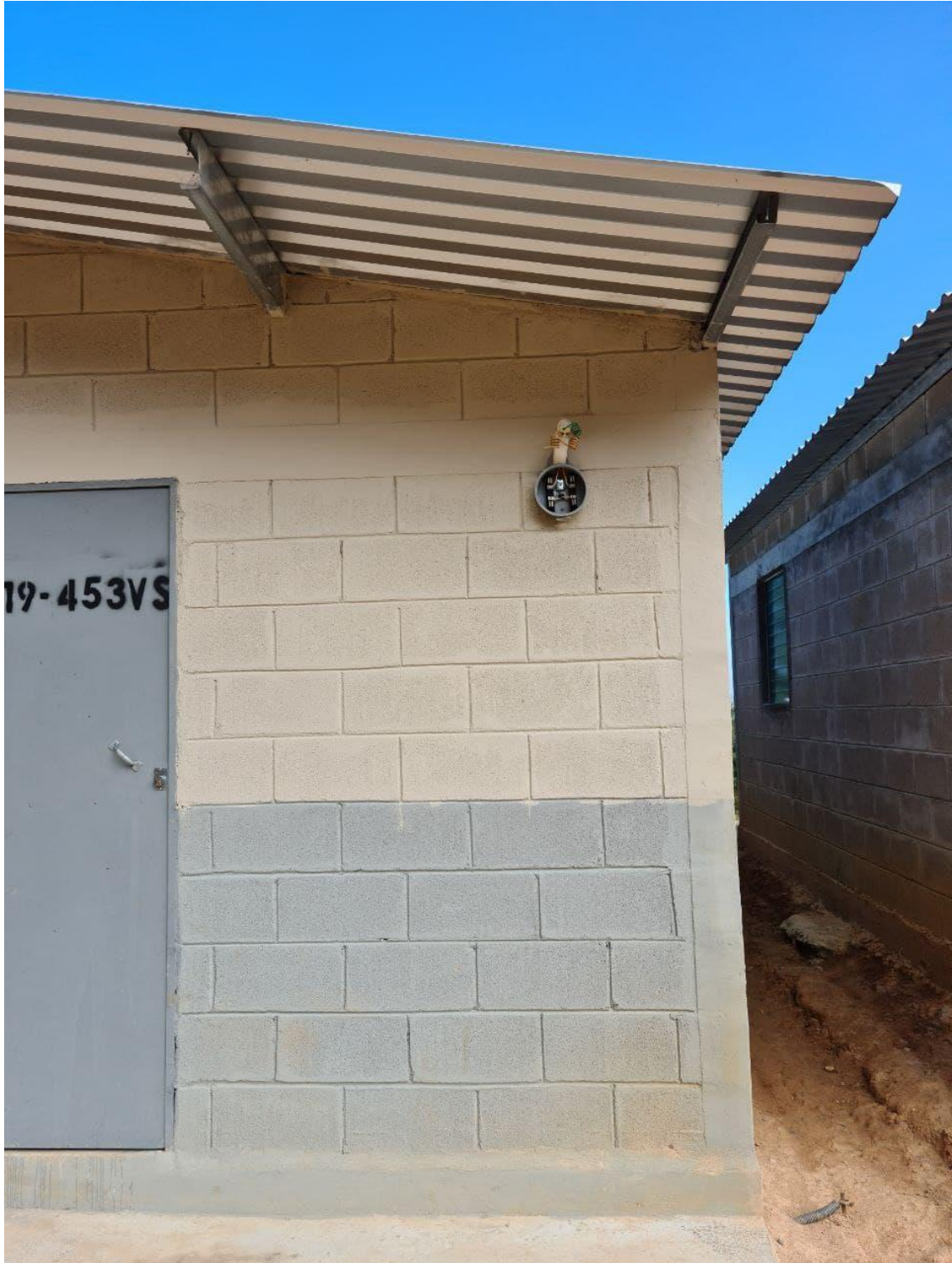
Ilustración 32 - Instalación eléctrica para el medidor en una de las viviendas
