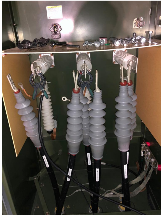
Ilustración 41. Pruebas eléctricas y aceite en transformador 3B
