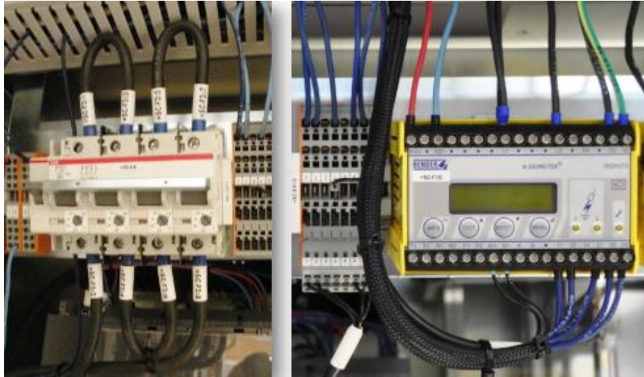
Ilustración 25. Combiner boxes sin funcionamiento
