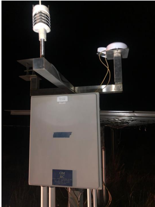
Ilustración 27. Revisión de batería de respaldo y de SunSaver
