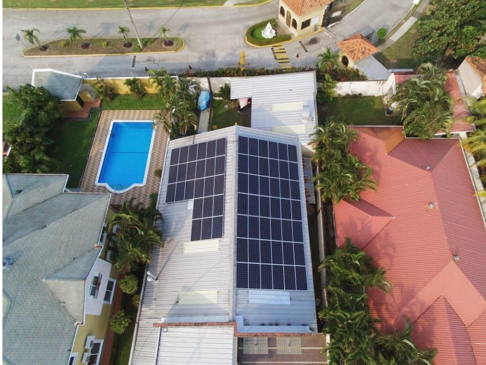
Ilustración 5 Instalación Fotovoltaica en techo
