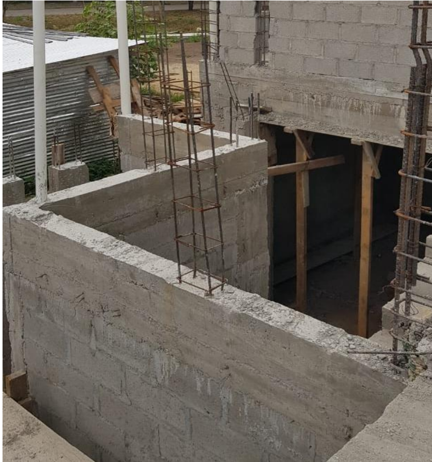
Ilustración 69. Error en altura de ventana de la fachada principal.
