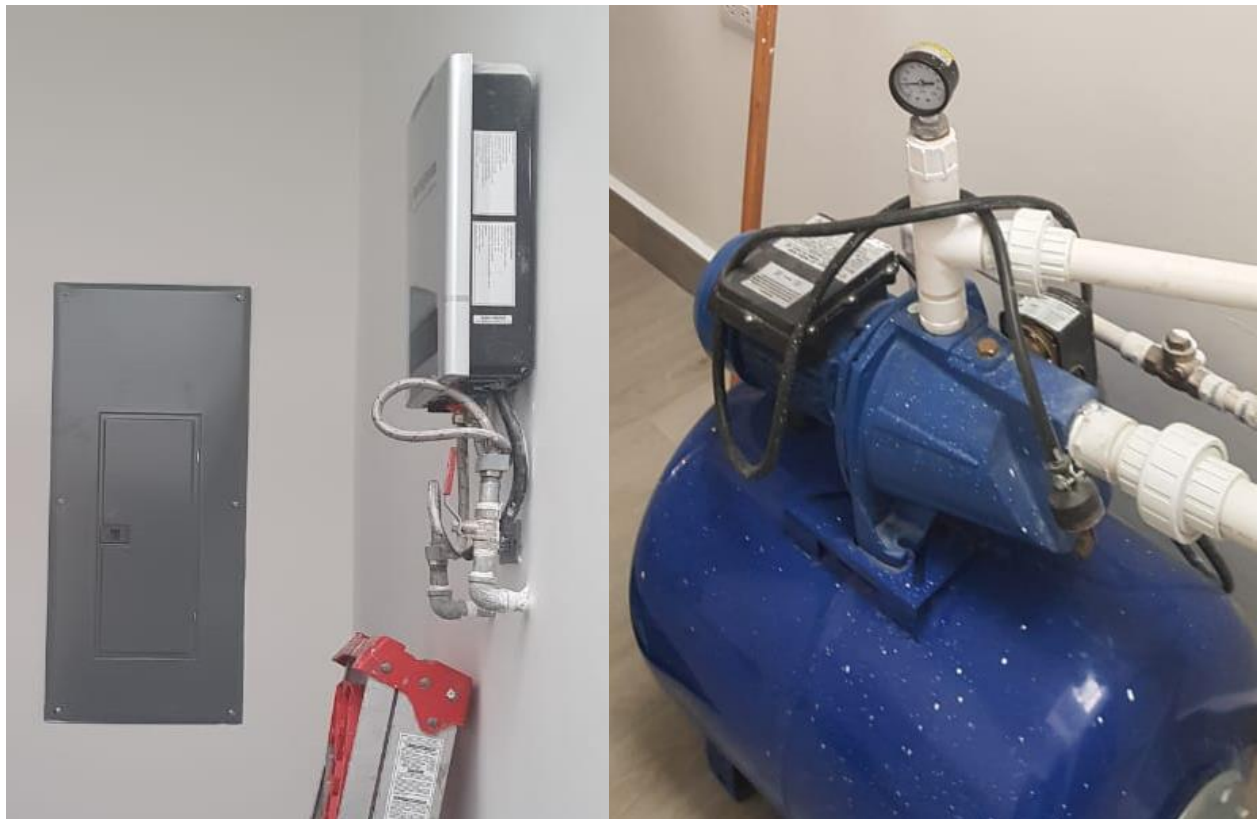
Ilustración 68. a) Panel eléctrico y calentador de agua. b) Bomba y tanque de agua.
