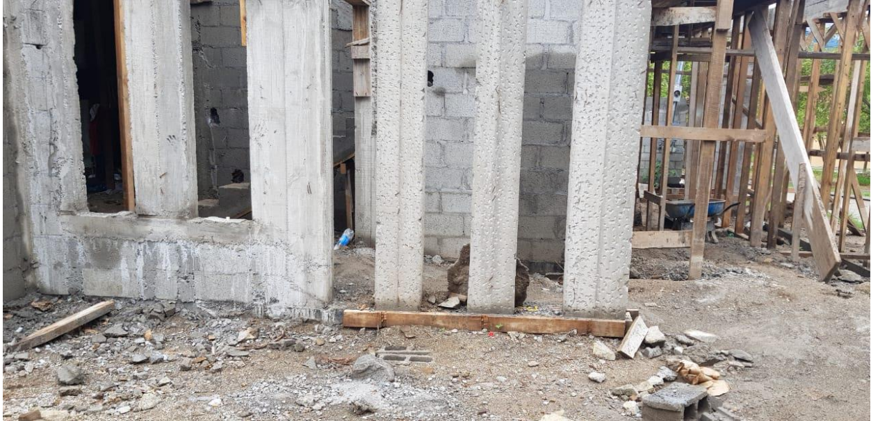
Ilustración 71. Falta de antepecho en columnas frontales.
