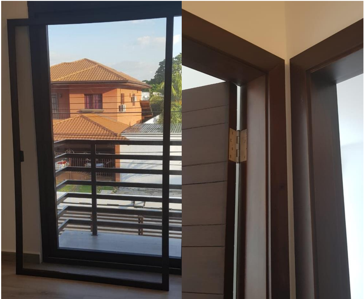
Ilustración 67. a) Desprendimiento de puerta de tela metálica en dormitorio principal. b) Falta de pintura entre puertas.
