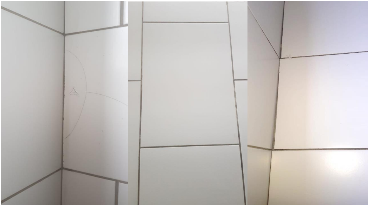
Ilustración 109. Error en el pegado de cerámica de baño de Torre 1 Residencia.
