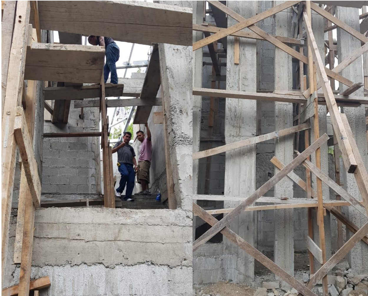
Ilustración 105. (a). Corrección de Ventana principal. (b). Falta de antepecho en vestíbulo de acceso.
