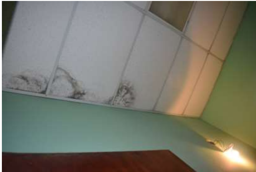
Ilustración 98. Signos de humedad en Clínica Municipal de Maternidad Juan Pablo II
