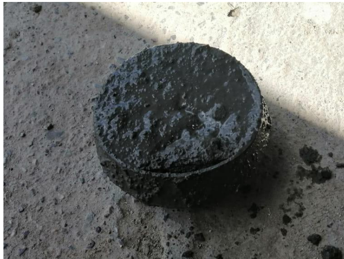
Ilustración 22. Presencia de material plástico en mezcla de concreto.
