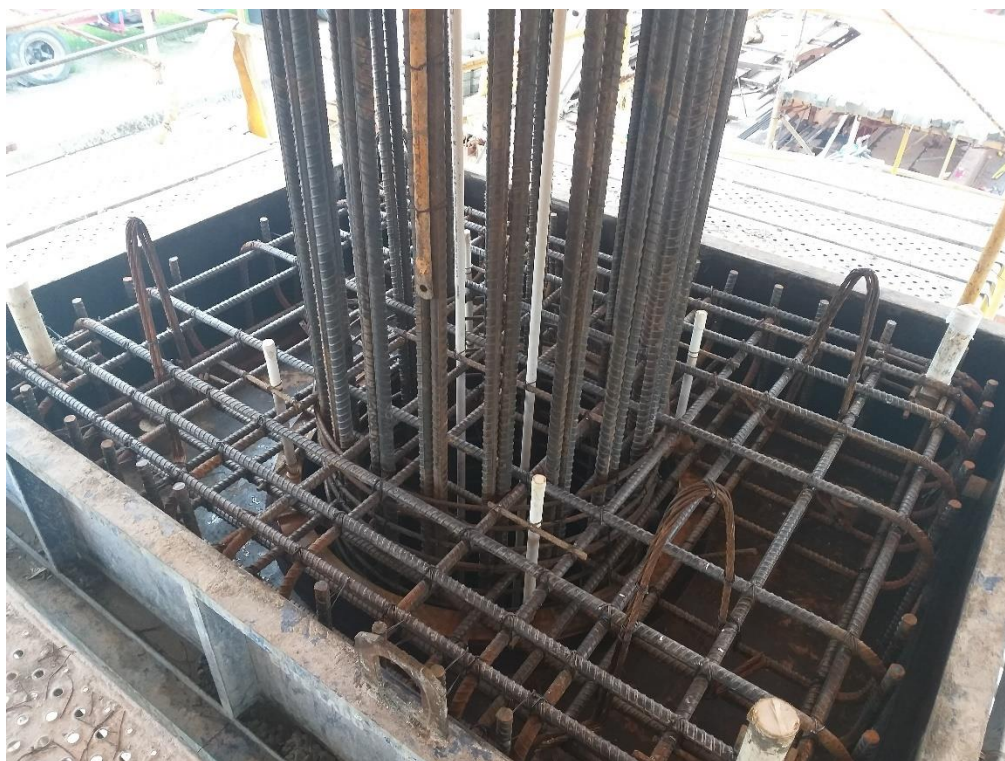
Ilustración 40 Preinspección de Capitel PC-6
