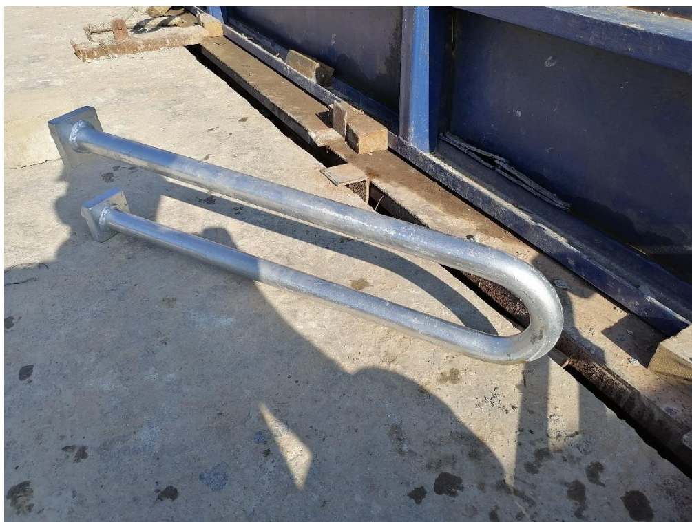
Ilustración 14 Perno de Anclaje de Losas DP-3, DP-6 y DP-9
