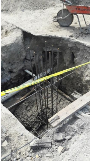
Ilustración 11- Zapata nueva en la construcción de nuevos locales en Mall Las Américas
