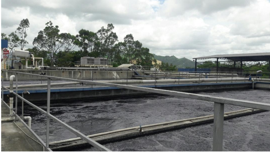
Ilustración 13- Visita a Planta de tratamiento en Choloma
