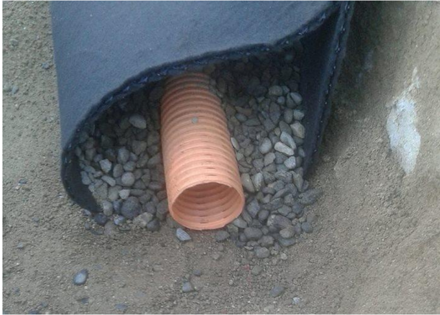
Ilustración 14. Tubería de 4" con Geomembrana para Muro.
