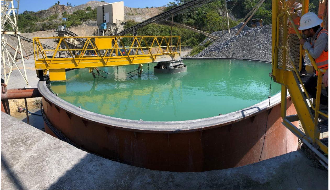
Ilustración 19. Tanque decantador existente en Agrecasa
