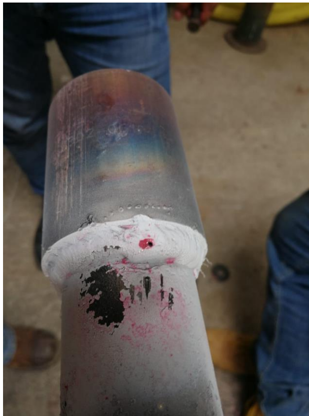
Ilustración 11: Localización de Poro en la soldadura.
