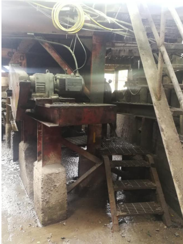
Ilustración 6: Área de rotores y gradas del primer nivel.
