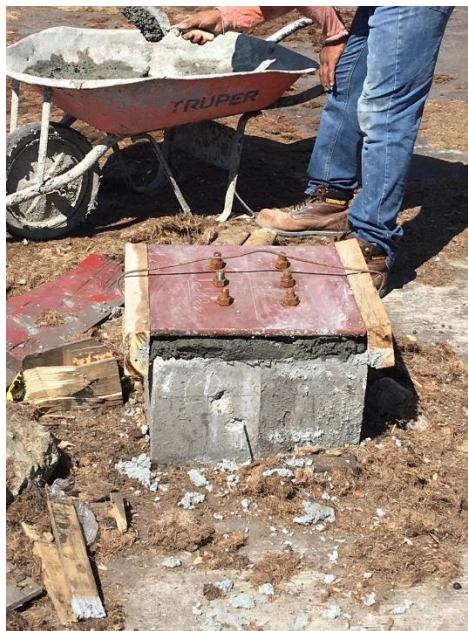
Figura 16. Vertido de 10cm de Grout entre la placa y el pedestal Biomasa.
