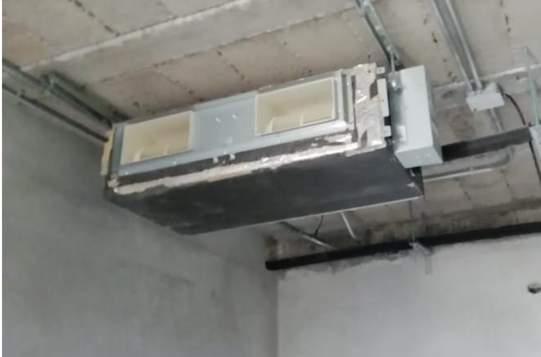
FIGURA 20. CENTRAL DE AIRE ACONDICIONADO INSTALADO POR GAMA TRAINING.
