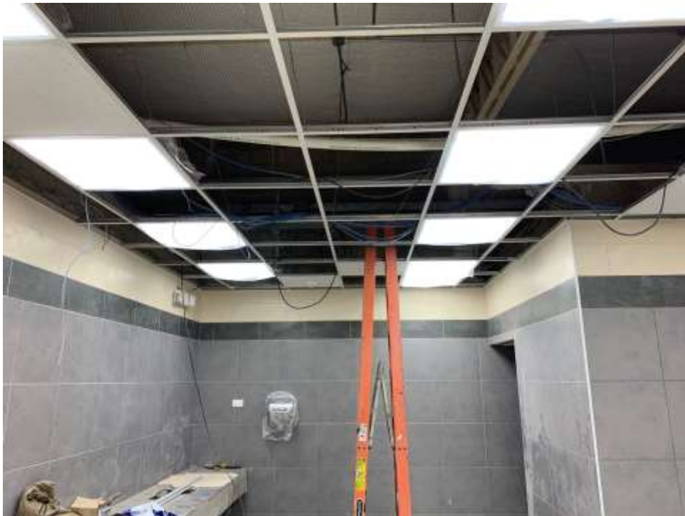
Ilustración 47 – Luminarias instaladas en el techo de los baños
