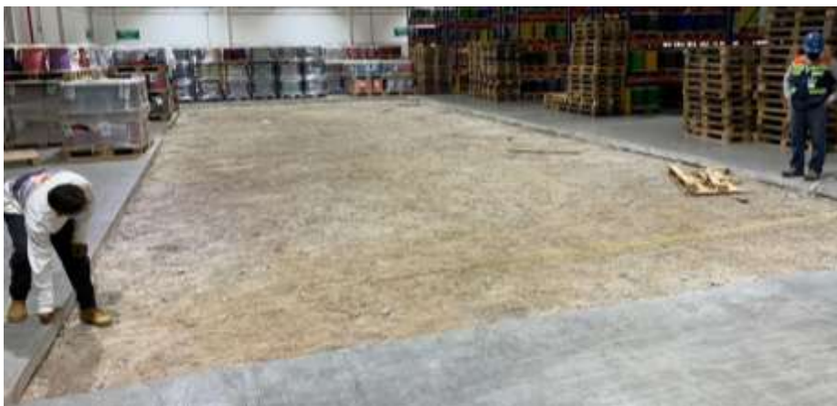
Ilustración 16 – Losa removida en la bodega principal de COFICAB
