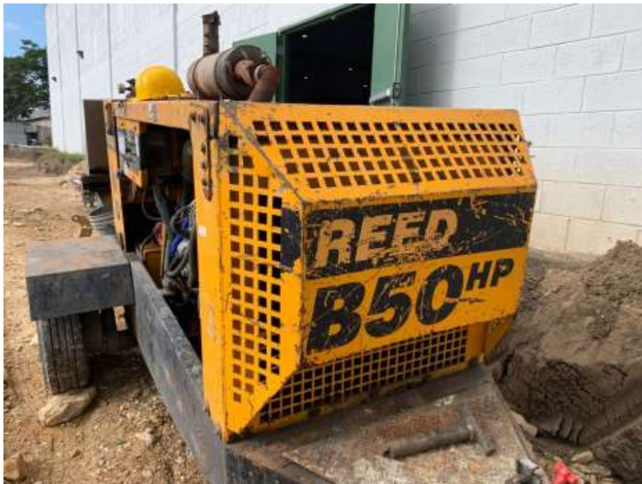
Ilustración 36 – Bomba para concreto marca REED B50 HP
