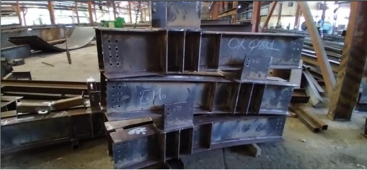
Figura1: Aquí en esta imagen se observan las piezas que se revisaron, una vez bien inspeccionadas a fondo y no se encuentran ningún tipo de defectos o reparaciones por hacer, se coloca utilizando una tiza, marcador o corrector "OK QSA" para que pasen por el proceso de Sand blast y luego a su acabado final en el área de pintura.
