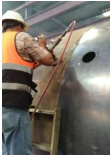
Figura 4: Aquí tenemos la siguiente imagen donde estábamos mi jefe inmediato el Ing. Noel Cruz junto a mi persona el practicante Andrés Muñoz en la prueba de vacío al tubo monitor del tanque de 8,000 galones para el proyecto UNO HONDURAS S.A. DE C.V. con OP-022-21 que iban para el municipio Campamento en Olancho.
