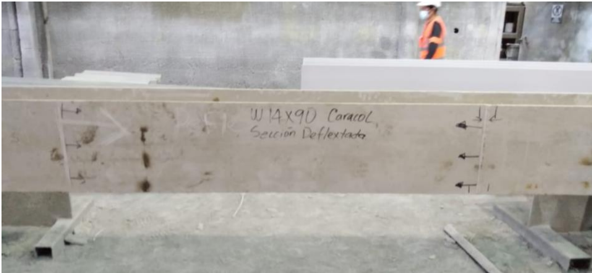
Figura 7: Se observa a continuación una imagen en el área de pintura donde esta viga W19x40 que iba para el proyecto de Caracol Knits, estaba con una deflexión en la zona marcada entre 1 a 4 cm, la longitud estaba alrededor de los 25 a 30 metros de largo, y esa deflexión estaba en la mitad cerca de la unión central de la soldadura.
