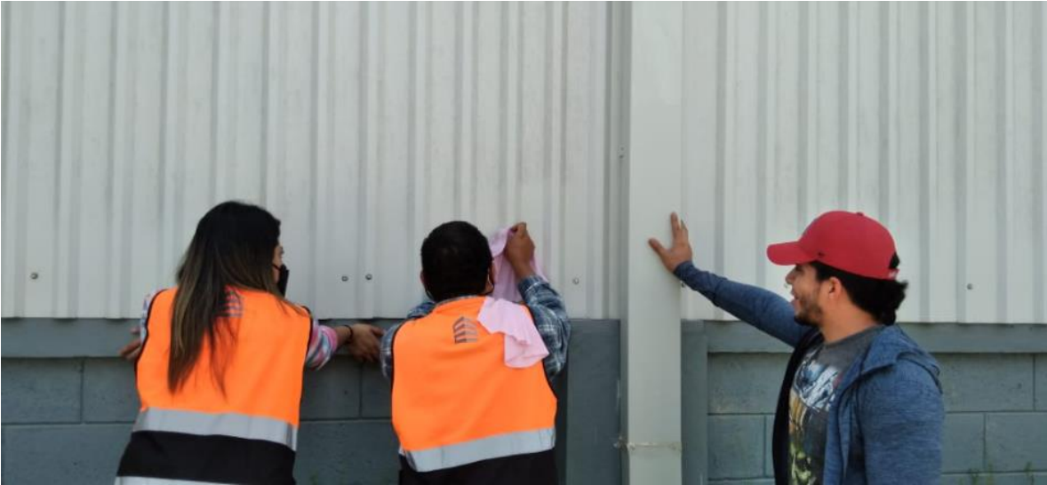
Figura 5: Aquí en esta imagen se puede apreciar que fuimos al proyecto ya terminado de Zede Morazán en Choloma a revisar una parte de las láminas de unas naves industriales que se empezaban a verse con un tono más oscuro que el resto, junto a la Ing. Kenia Meza (Gerente general de Sistema de Gestión), el Ing. Noel Cruz y el Ing. Residente y supervisor que estaba ahí por el cliente.
