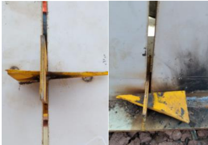
Figura 8: Aquí se pueden ver dos imágenes donde se ve la separación en el cuerpo del tanque y que no había manera de unirla más por lo que se explicó que usarían más soldadura en esta parte para poder rellenar bien esa parte y que no vaya a haber problemas con respecto a fugas o filtraciones de agua después.
