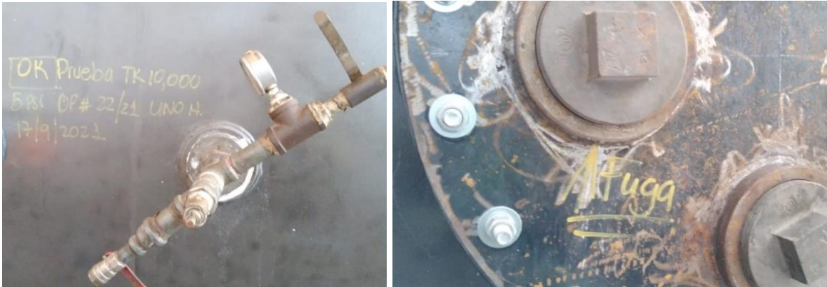
Figura 5: En esta imagen podemos ver que se le hizo una prueba de vacío al tanque de 10,000 Galones y del cual salieron unas fugas o filtraciones en la parte del manhole como se puede observar en la imagen de la derecha.
