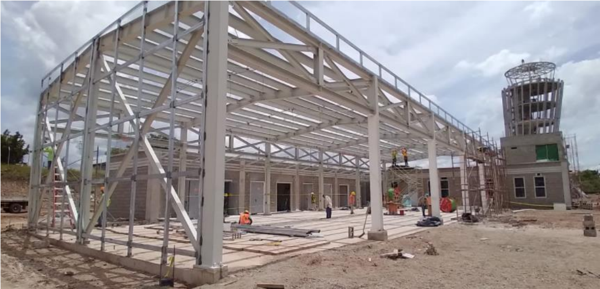
Figura 7: Aquí tenemos la instalación SEI (Servicios Eléctricos Industriales) en su etapa de construcción.
