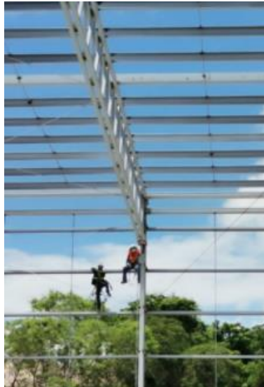
Figura 6: Y por último tenemos la siguiente imagen donde se me ve a mi persona (el practicante Andrés Muñoz) junto con el Ing. Noel Cruz subiendo la estructura completa del proyecto de INCAL con la nave industrial.
