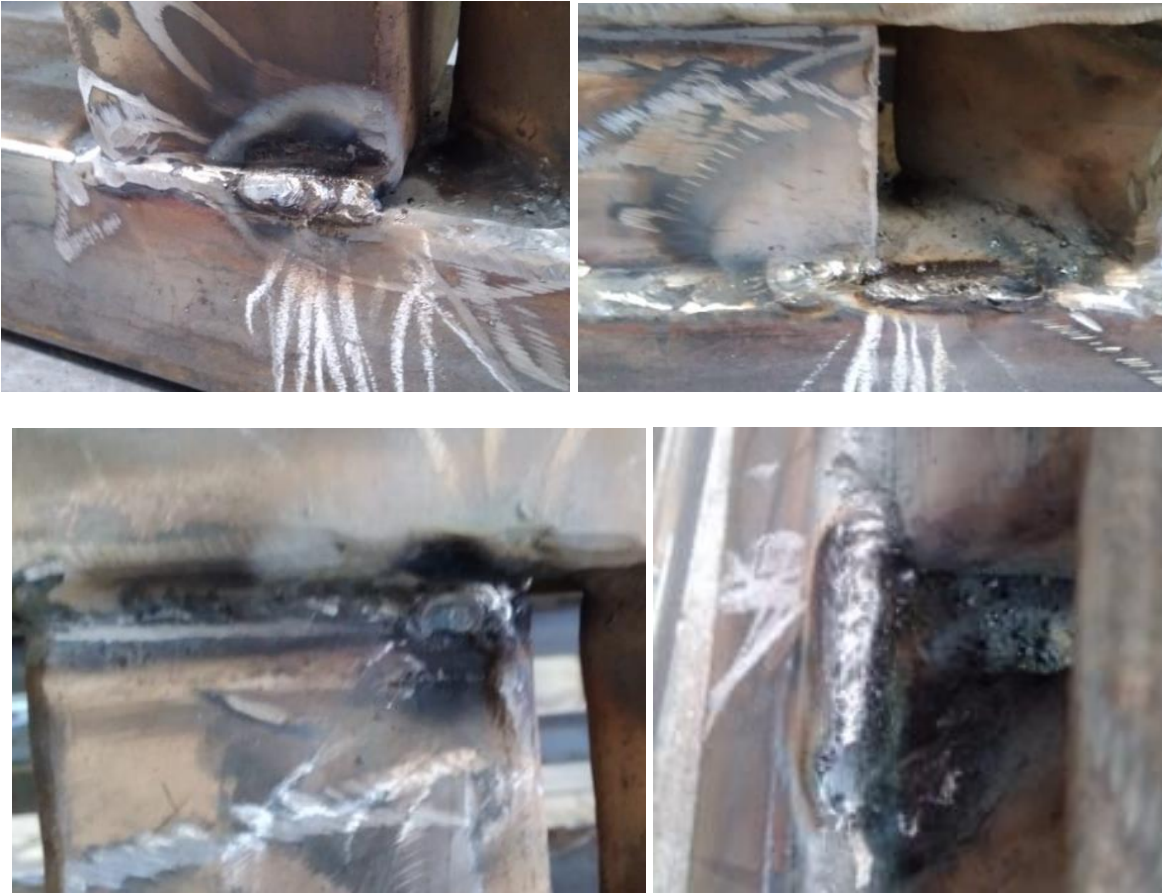
Figura 11: Aquí en esta parte hay cuatro imágenes donde se hicieron las reparaciones debidas a los Joists que se revisaron el día miércoles para que no salieran con una calidad no tolerable para este tipo de estructuras metálicas. Las reparaciones fueron por socavaciones poros bastante visibles, mala aplicación de la soldadura y falta de soldadura en algunas secciones donde si tiene que haber para que.
