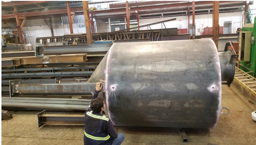
Figura 3: Se observa como mi persona el practicante Andrés Muñoz hizo la prueba de la inspección de soldaduras con tintas penetrantes a un tanque vertical de 1,000 galones
