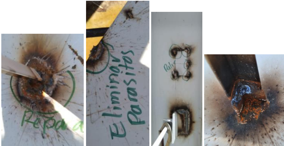
Figura 5: Aquí se puede observar imágenes de las discontinuidades que encontramos en el proyecto de INCAL de izquierda a derecha se ve como es necesaria una reparación con una buena pulida y mejor aplicación de la soldadura, la segunda imagen existen parásitos que se necesitan limpiar con la pulidora para que después con el acabado de pintura se observe bien, la siguiente es necesario pulir donde antes habían colocado la oreja del tensor, y la última una buena limpieza y una mejor aplicación de soldadura en la unión entre esos dos ángulos y con la unión de ese ángulo pequeño con la base de la viga.
