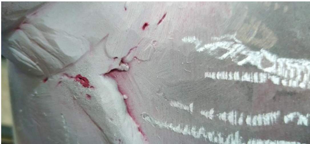
Figura 4: Se observa el resultado de la inspección indicando que en toda esa parte de rojo se utilizó el tinte penetrante en conjunto con el tinte revelador para detallar esos espacios la soldadura del tanque donde se necesita reparar.
