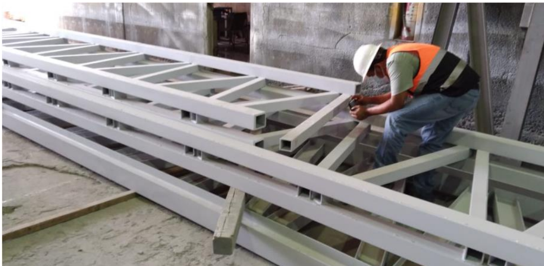
Figura 4: Aquí tenemos la siguiente imagen donde estábamos con mi Jefe Inmediato el Ing. Noel Cruz, evaluando unas vigas Joist, encontrando algunos defectos en la calidad de la soldadura, así como detalles de salpicaduras que no se hizo una buena limpieza con respecto a la escoria, y otros problemas con el pulido de las soldaduras.
