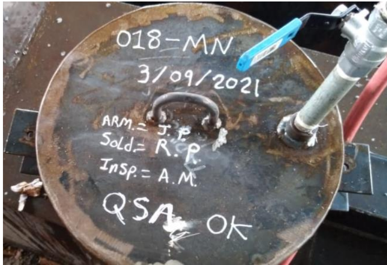
Figura 5: Esta imagen es para observar el estado de este flotador o indicador del nivel de agua para el tanque de la Inmobiliaria Nola paso la segunda prueba de fugas luego de las dos reparaciones que se habían marcado, colocando "OK QSA", la marca, la fecha en que se realizó, el inspector que en este caso es mi persona el practicante Andrés Muñoz, el armador y su soldador.
