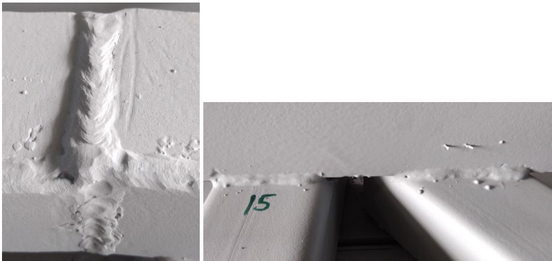
Figura 4: Aquí se logra ver las no conformidades que encontramos en la tijera que revisamos donde la imagen de la izquierda se ve que tiene refuerzo excesivo con una socavación debajo, falta pulir bien y en la imagen de la derecha se ve que no se hizo la limpieza adecuada en las soldaduras y al igual que en la imagen anterior hay puntos socavados.
