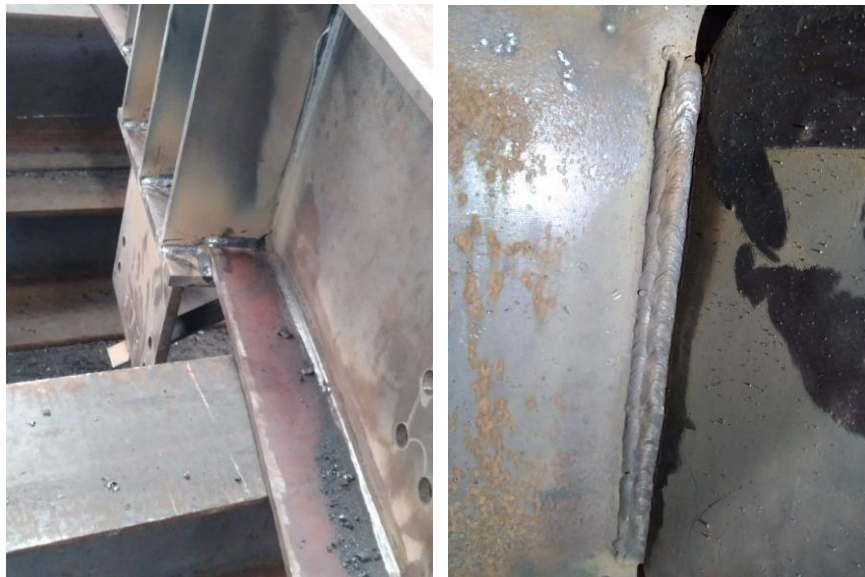
Figura 2: Se observa la calidad de soldadura de la pieza vista anteriormente, en la imagen de la izquierda si cumplía con la tolerancia, en la imagen de la derecha se mandó la foto para su reparación inmediata así como otras áreas con el mismo problema "Mala aplicación de soldadura, y en este caso una socavación donde el metal base de la pieza se funde.
