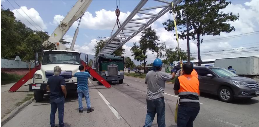
Figura 7: Y por último tenemos esta imagen donde se estaban acomodando de nuevo los Joists que estaban en el suelo después de haber hecho un perímetro con los conos para que estos no pasaran y en dicho caso que exista la posibilidad de otro accidente con el uso de una grúa de la misma empresa.
