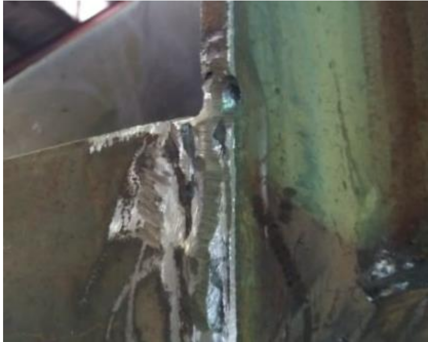
Figura 1: Aquí en esta imagen se observa un golpe el cual tuve que señalar y marcar junto a otro que estaba en otra pieza, pero era el mismo tipo problema, así que se reparó y se envió área de pintura para su acabado final.
