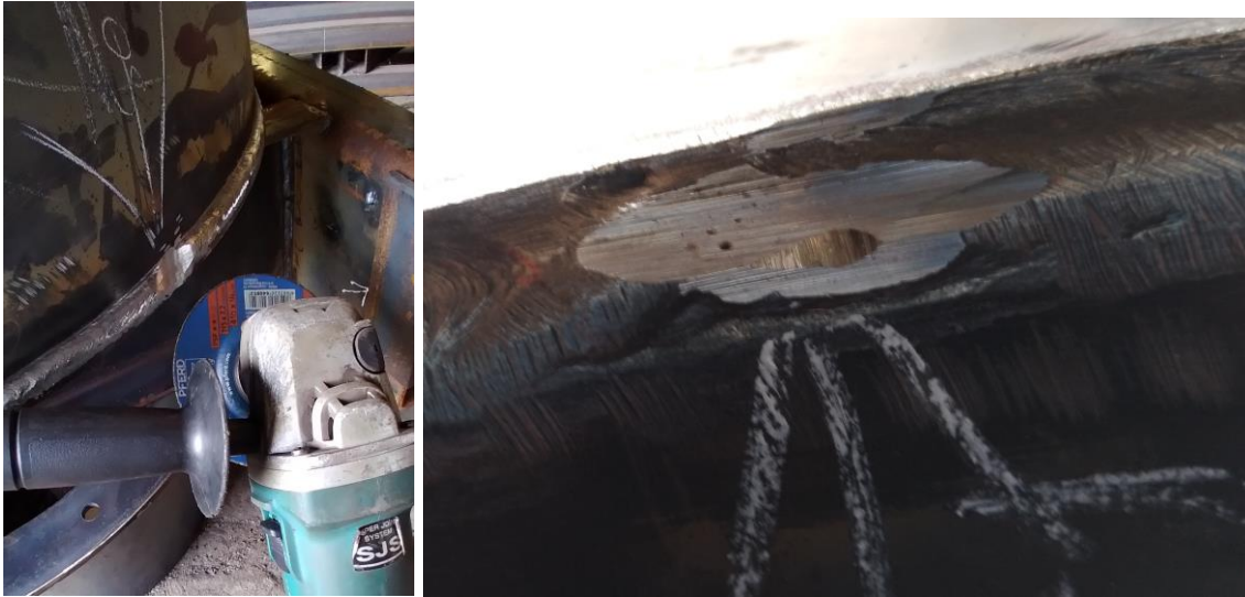
Figura 5: Aquí se puede observar imágenes de un sumidero al cual le encontramos detalles en la soldadura que debían de reparar, y en estos casos donde se observan la no conformidad de la porosidad mi jefe inmediato el Ing. Noel Cruz me pregunto si quería investigar más a fondo a ver si solo era un poro superficial o había más a medida uno iba puliendo, y si se encontraron más pero adquirí una nueva experiencia usando la pulidora, así que solo señalamos donde eran necesarias las reparaciones y listo.
