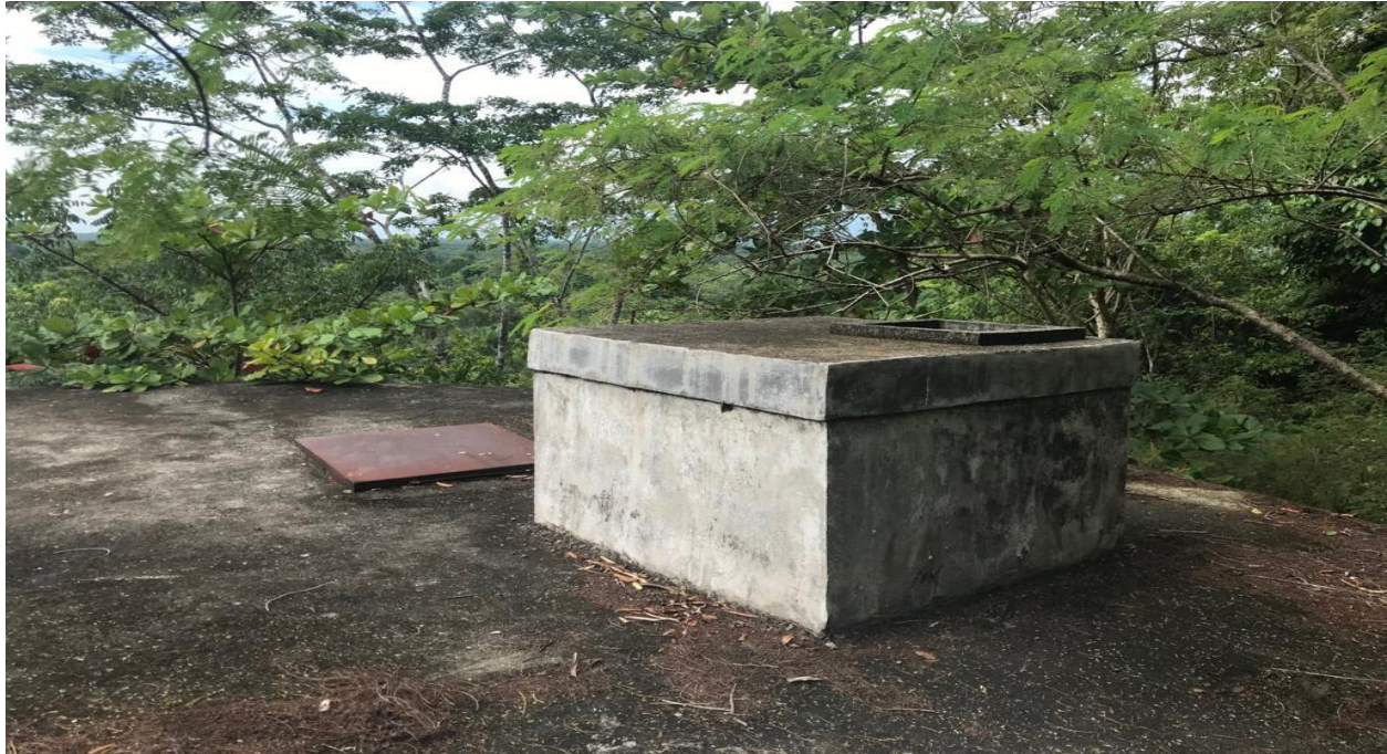
Ilustración 22. Parte de superior de tanque de almacenamiento (Hipoclorador)
