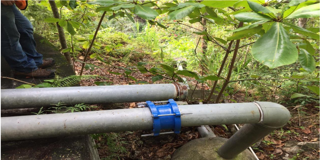
Ilustración 20. Conexiones existentes en tanque de almacenamiento
