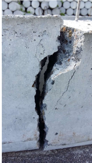
Figura 70. Falla de corte V2 10%
