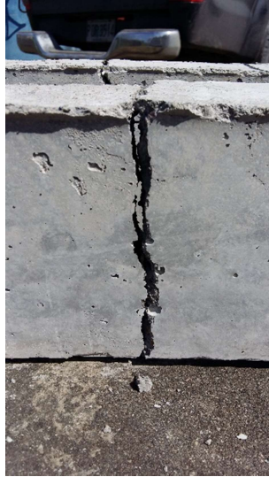
Figura 68. Falla de corte V1 10%
