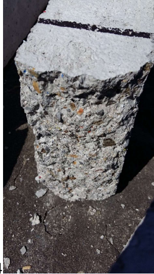
Figura 66. Falla de corte V2 20%, sección transversal
