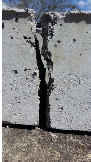
Figura 60. Falla de corte V1 30%
