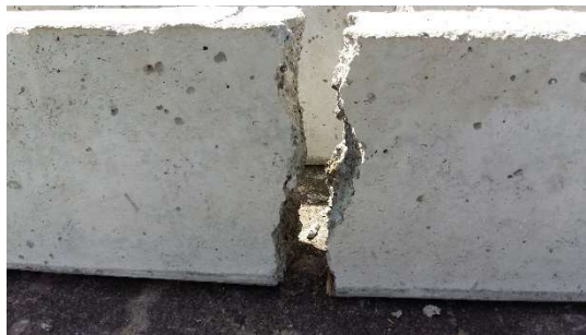
Figura 61. Falla de corte V2 30%
