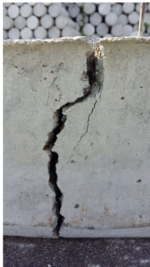
Figura 69. Falla de corte V2 10%
