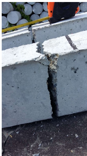
Figura 65. Falla de corte V2 20%
