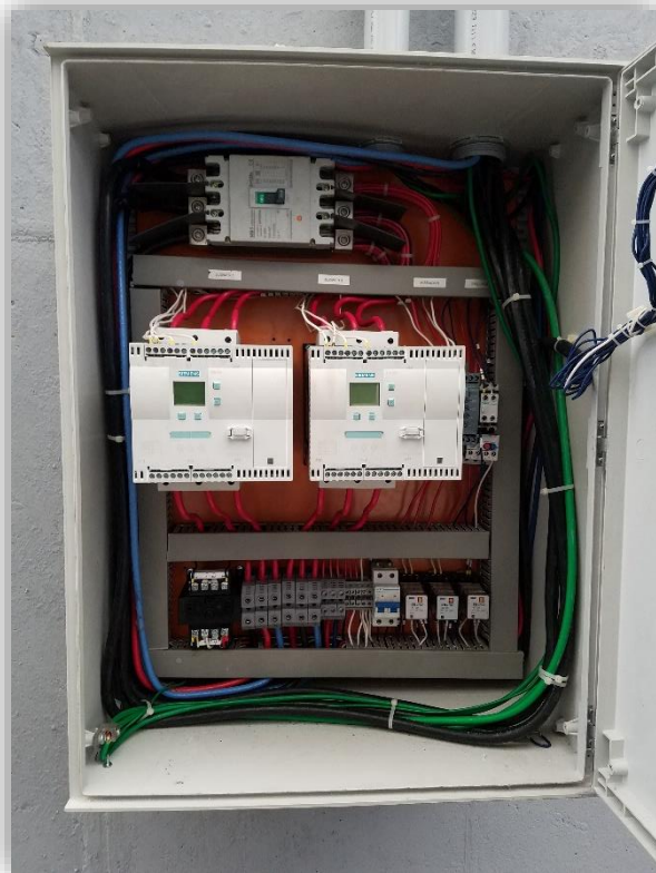
Anexo 8. Soft starter instalado y parametrizado Techno Supplier
