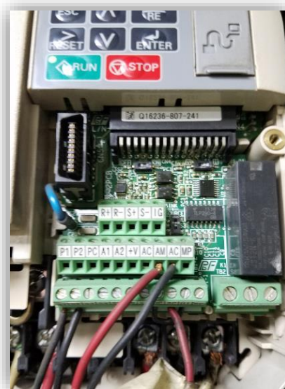
Ilustración 17. Cableado circuito de control
