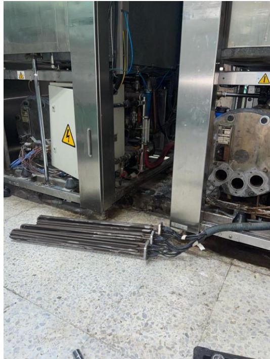
Ilustración 35: Resistencias de Autoclave Matachana Serie 1000 Durante Mantenimiento Correctivo
