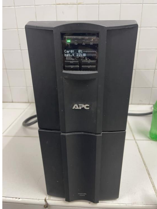
Ilustración 36: UPS de Patología
