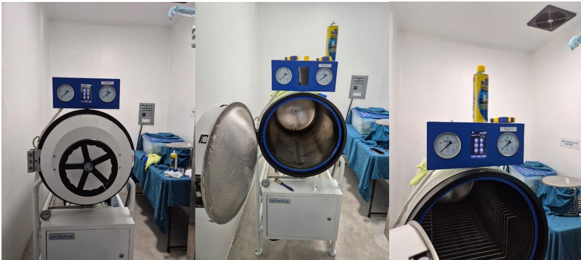
Ilustración 46 - Mantenimiento preventivo a autoclave de CEYE
