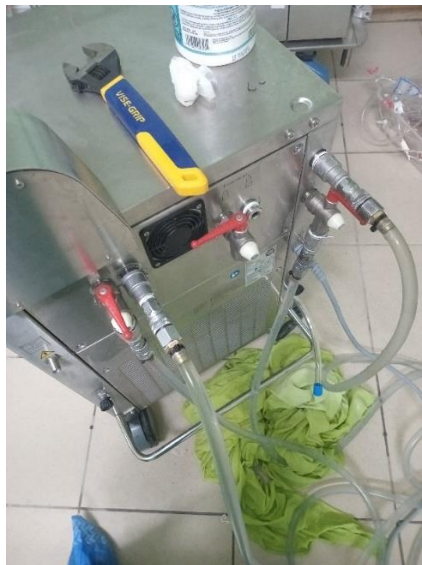
Ilustración 21: Limpieza Interna de Circuito Hidráulico de Intercambiador de Calor Marca-Stöckert, Modelo-Liva Nova 3T Heater-Cooler
