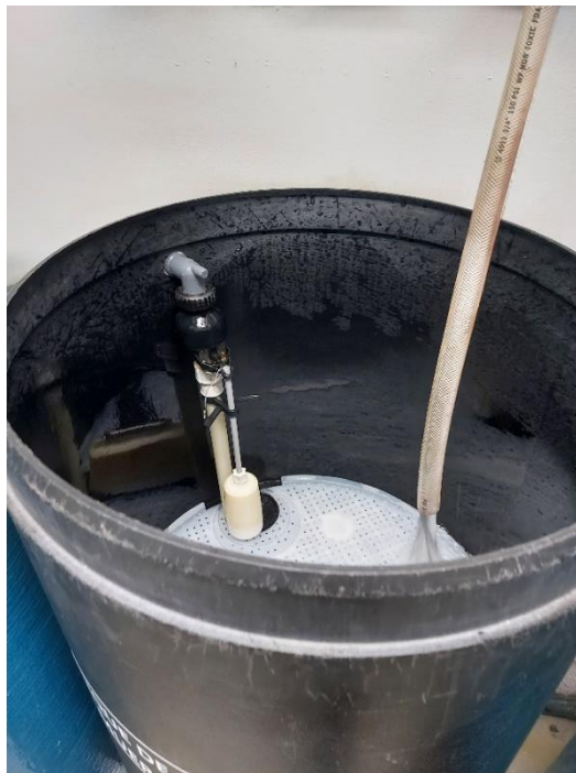
Ilustración 72- Desinfección del tanque de salmuera
