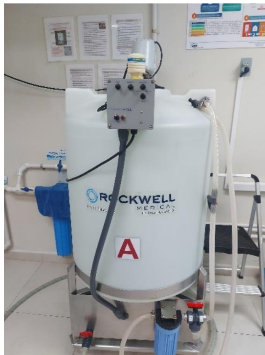
Ilustración 13- Tanque para preparación de solución ácida
