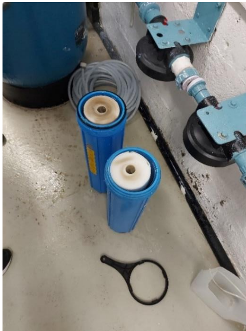
Ilustración 20- Reemplazo de filtros pulidores
