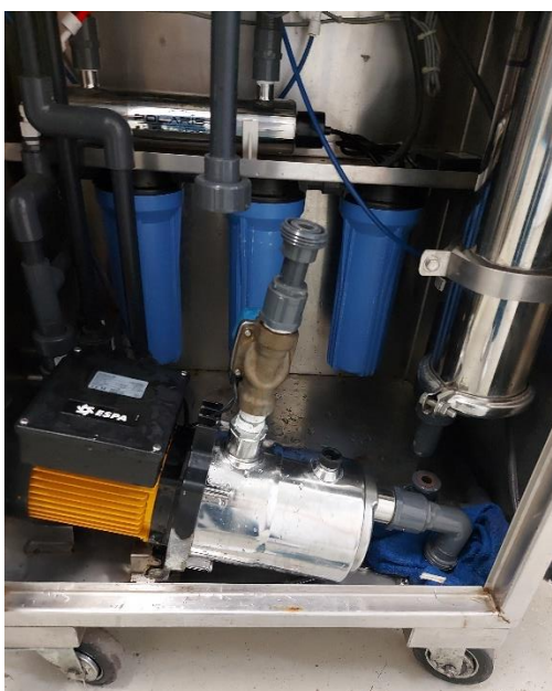
Ilustración 47- Motor con falla en osmosis portátil
