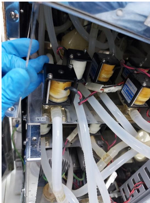
Ilustración 40- Revisión de válvulas de máquina #32
