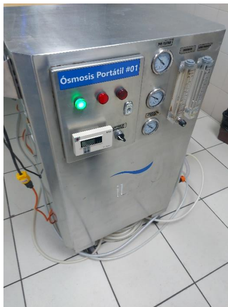
Ilustración 45- Conexión de equipos en Observación
