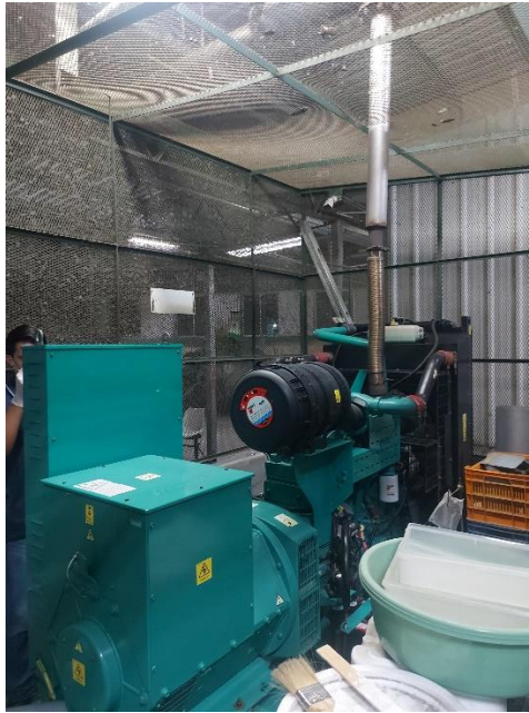
Ilustración 44- Revisión y limpieza a planta eléctrica
