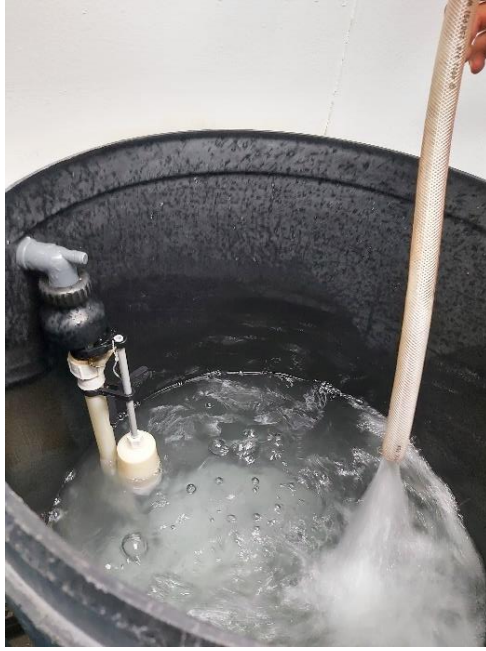
Ilustración 63- Desinfección del tanque de salmuera
