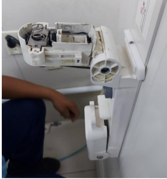
Ilustración 73-Reemplazo de pieza quebrada de brazo de bicarbonato
