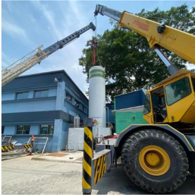
Anexo 7 Tanque de oxígeno criogénico IHSS
