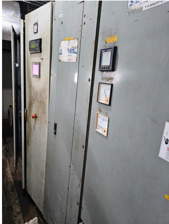
Figura 26. Panel de control motor Guascor Fuente: (Eecopalsa, 2025)
