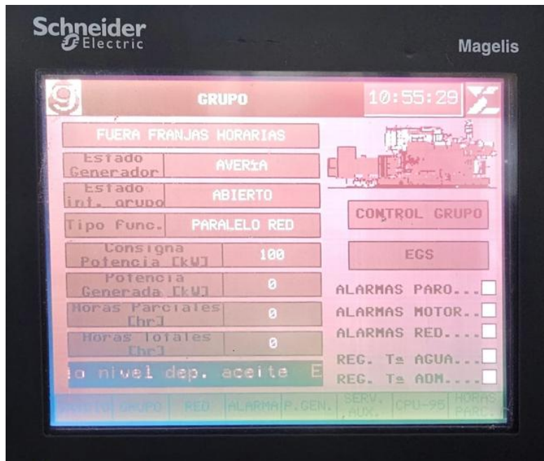
Figura 27. Panel de control motor Guascor Fuente: (Eecopalsa, 2025)
