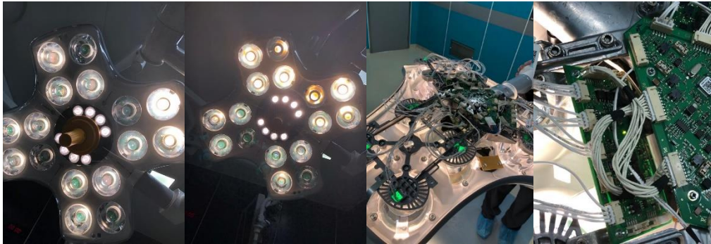
Ilustración 19 Identificación de falla en placa de control de leds.
