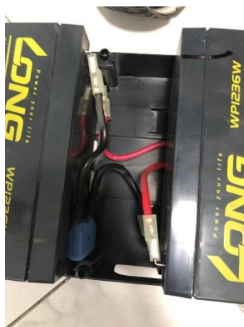
Ilustración 35 Baterías de UPS.
