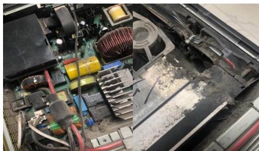
Ilustración 26 Estado interno de UPS previo a limpieza
