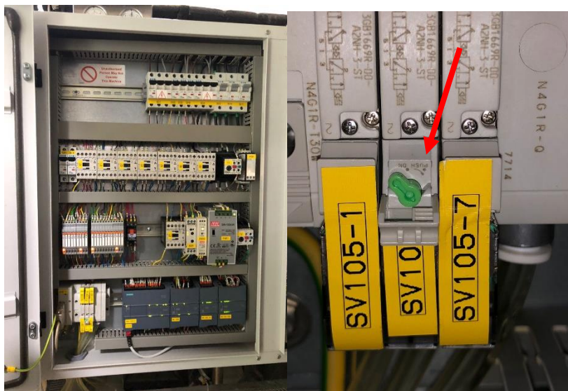
Ilustración 14 PLC de esterilizador y electroválvula de vacío
