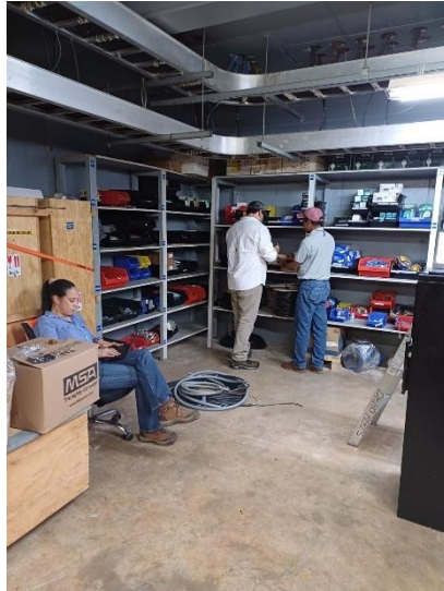
Ilustración 1 Elaboración Propia. Toma de Inventario Planta Hidroeléctrica Cuyamapa.
