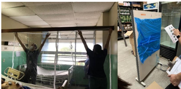
Ilustración 57 - Cámara de presión negativa
