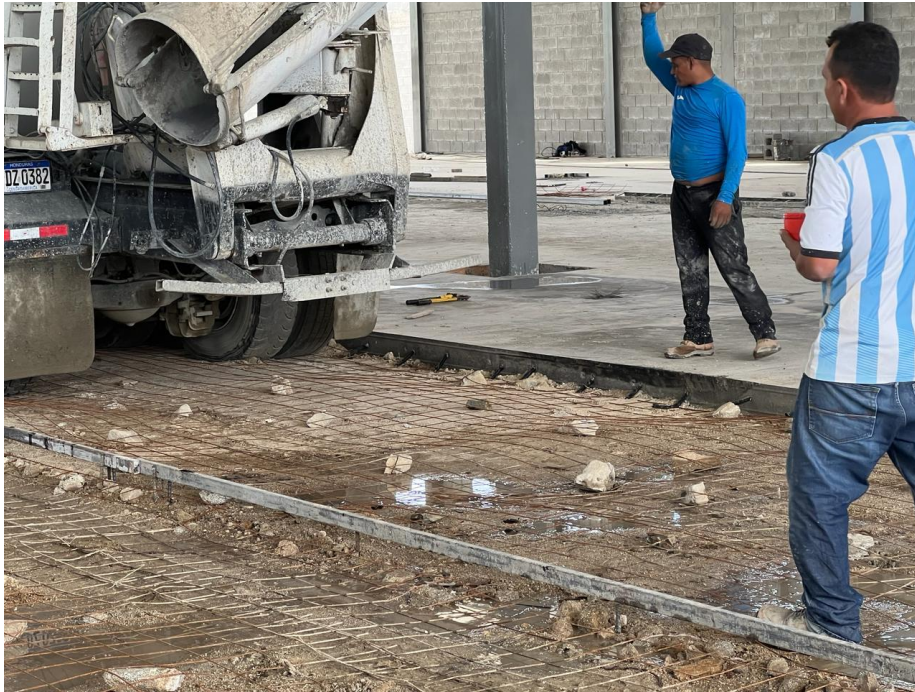
Ilustración 42 – Daño en varillas de transferencia de esfuerzos
