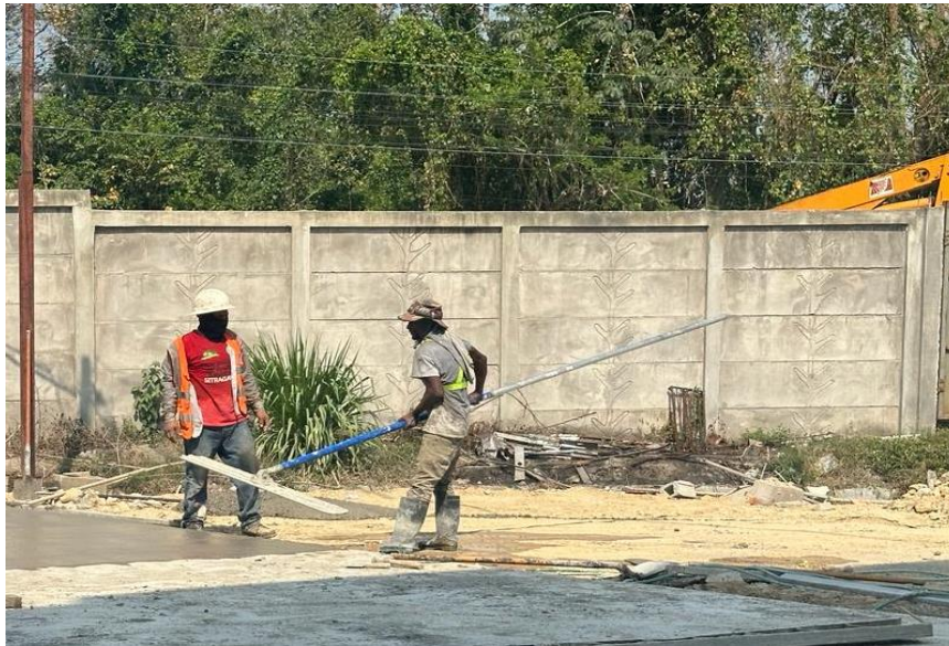
Ilustración 98 – Dianado sobre pavimento
