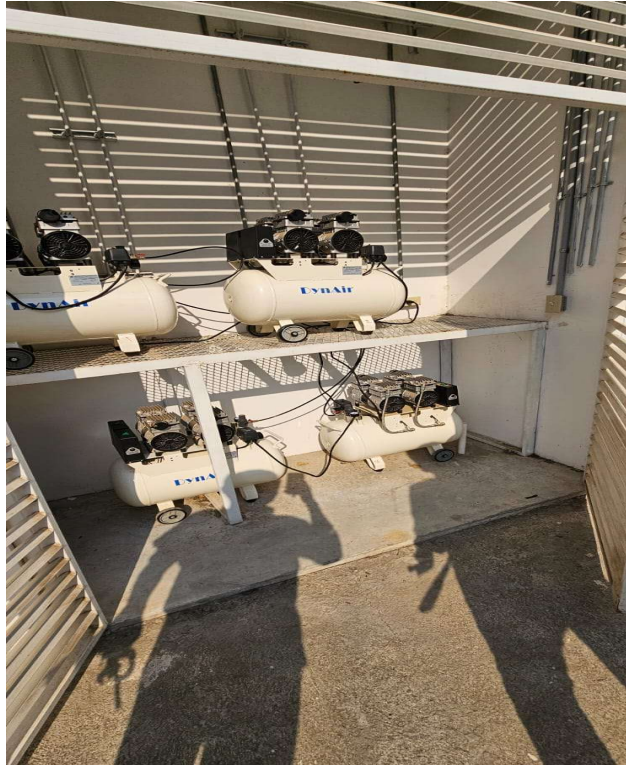
Anexo 15.- Comprobación de Funcionamiento de compresores (ROSON)
