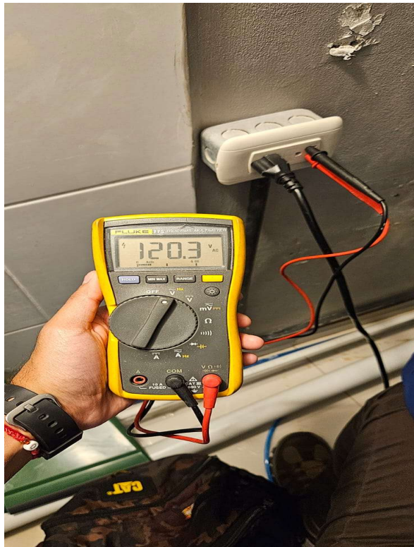
Ilustración 56.- Adquisición de datos eléctricos para proceso de garantías ROSON Clínica II
