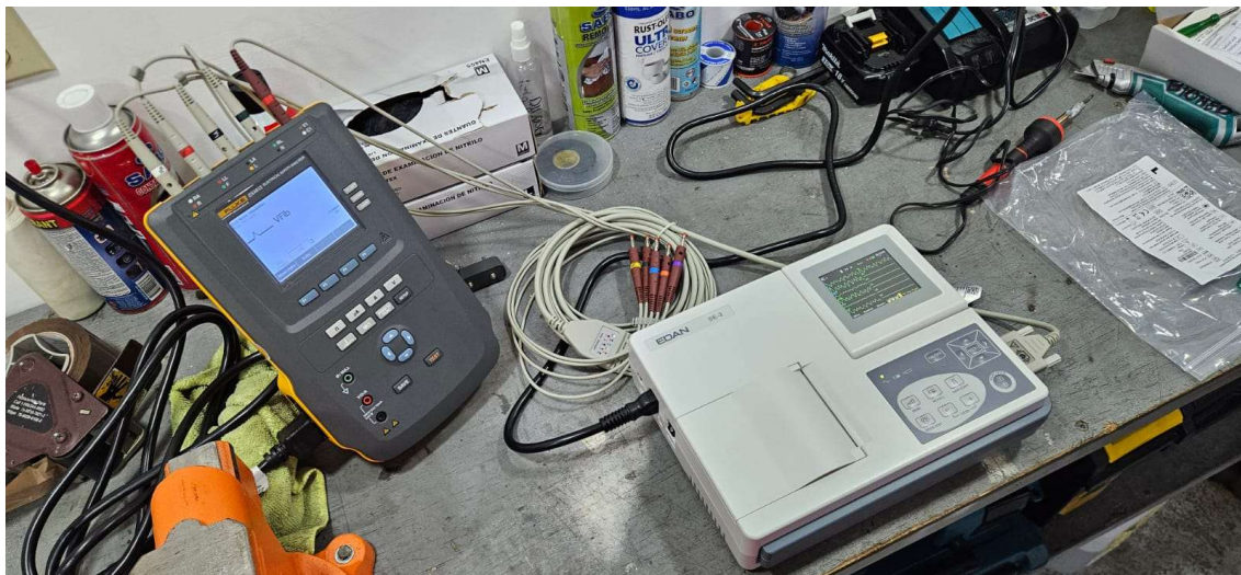
Ilustración 71.- Pruebas de Funcionamiento con Analizador FLUKE
