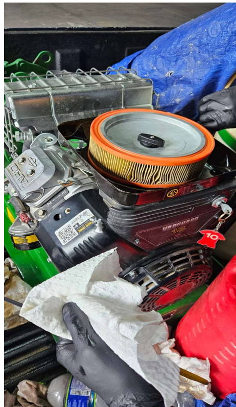
Ilustración 102.-Limpieza de filtros, nivelación de aceite y funcionamiento general
