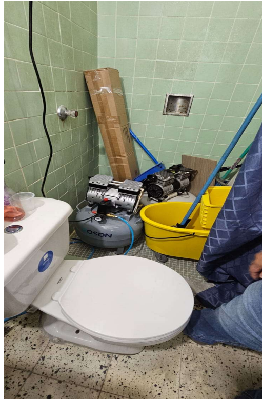
Ilustración 82.- Revisión y purgado de compresor
