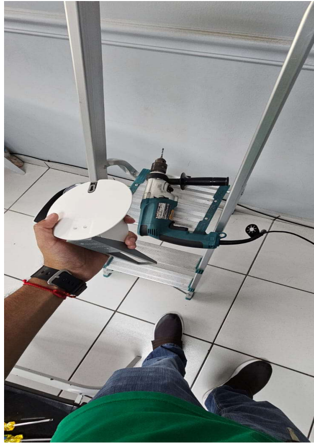
Ilustración 17.- Instalación Tallímetro Hospital Ferraro
