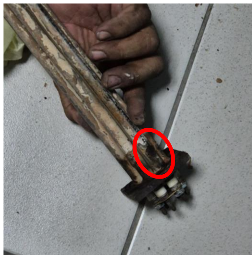
Ilustración 60: Juego de Resistencias Dañado
