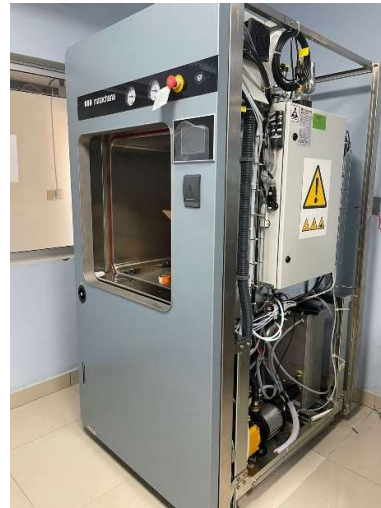
Ilustración 26 Instalación de equipo Matachana
