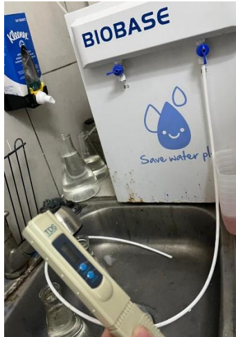
Ilustración 36. Verificación nuevos filtros para desionizador.
