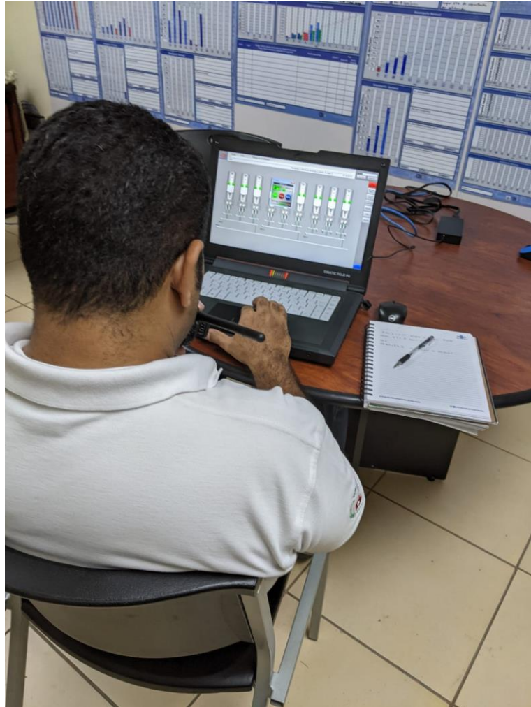
Ilustración 9 Pruebas de control remoto en SCADA
