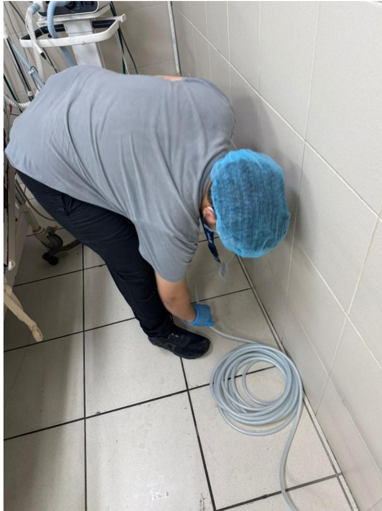
Ilustración 42: Instalación de osmosis inversa en observación adultos
