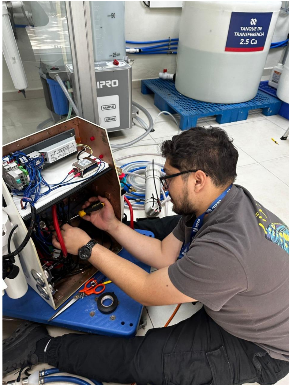
Ilustración 44: Mantenimiento correctivo osmosis inversa portátil
