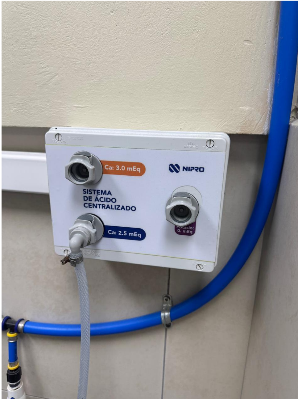
Anexo 5: Toma mural del sistema de ácido centralizado
