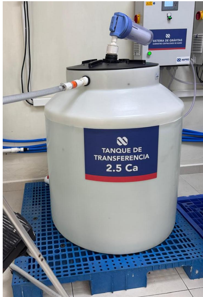
Ilustración 19: Tanque de transferencia 2.5 Ca
