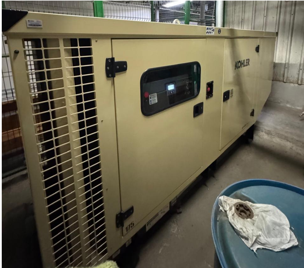
Ilustración 41: Limpieza de generador eléctrico marca Kohler
