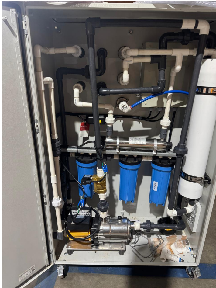
Ilustración 36: Fabricación de osmosis inversa
