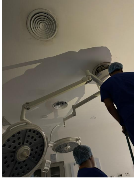
Ilustración 30-Revisión de instalación y MP de Lámpara Cielítica
