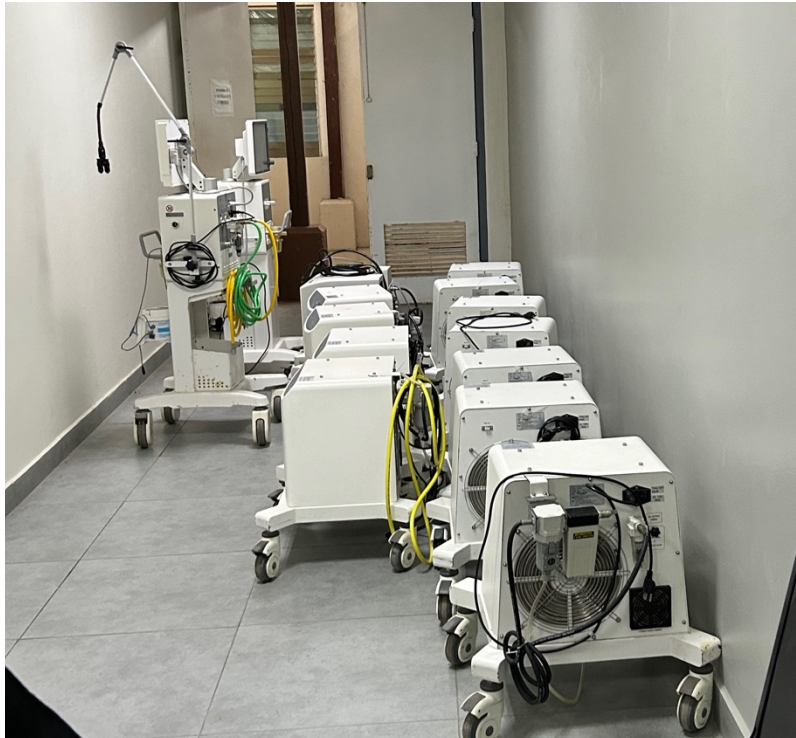
Ilustración 23. Compresores de aire y VM trasladados.
