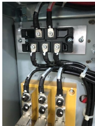
Ilustración 12. Cambio de arreglo de Diodos rectificadores de un PDU.
