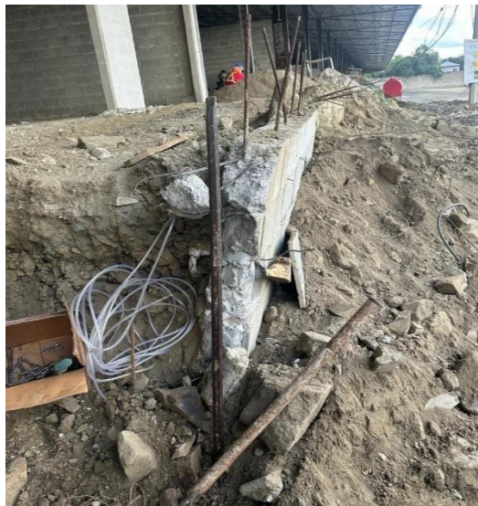
Ilustración 38- Destrucción de muro por falla lado frontal
