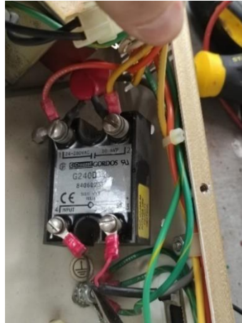
Ilustración 49 – Relé de estado sólido en mal estado
