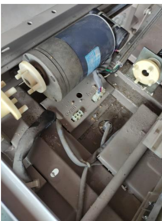
Ilustración 17 – Empaques del motor destruidos
