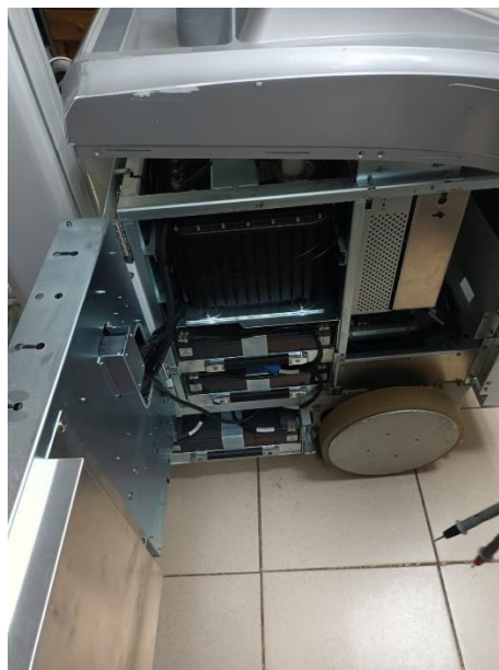
Ilustración 5. Equipo de Rayos X (banco de baterías) Fuente: Propia (2022)
