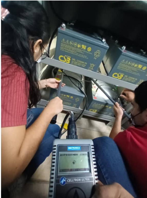
Ilustración 18. Banco de baterías de UPS de RM. Fuente: Propia (2022)
