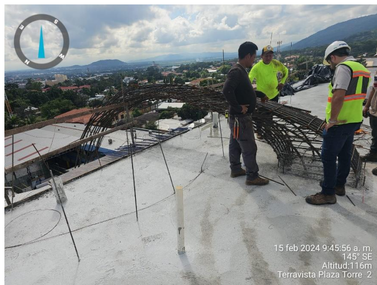
Ilustración 28 Caída de armado de Columna
