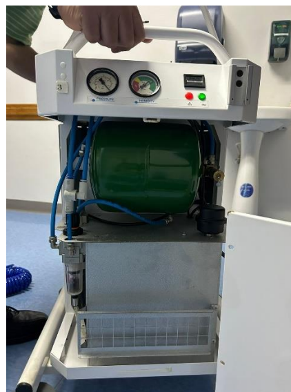
Ilustración 65 - Mantenimiento correctivo de compresora de aire médico
