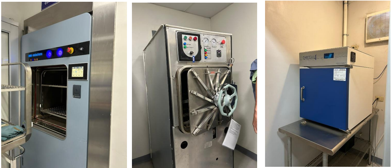
Ilustración 60 - Autoclaves de área de CEYE
