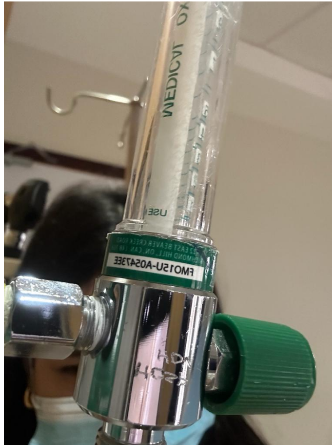
Ilustración 98 - inspección de flujómetro
