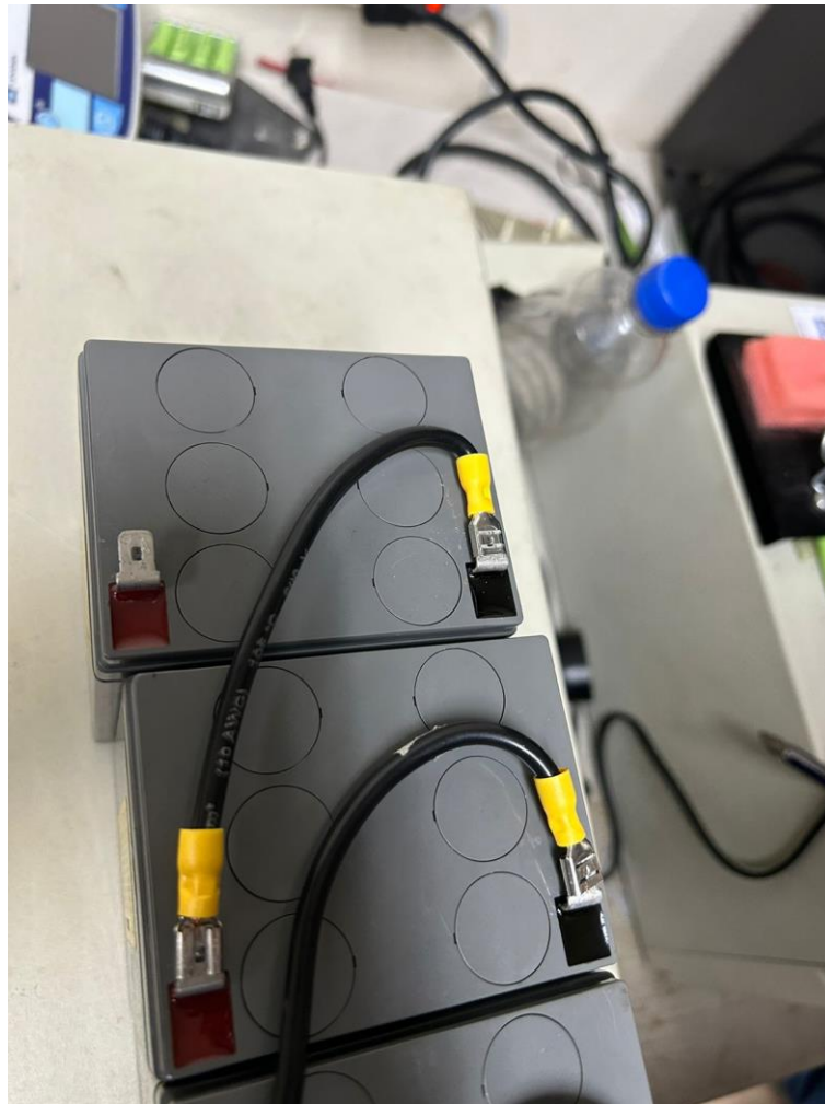
Ilustración 72 - Baterías de 12 V
