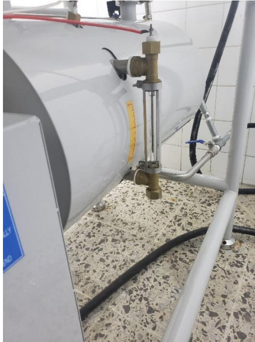
Ilustración 39. Sensor de nivel de agua en autoclave de vapor en SUPPORT
