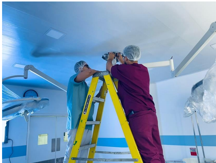
Ilustración 54. Empalme de cables de alimentación en lampara cialítica
