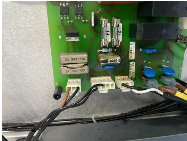
Ilustración 68 – Placa de láser quirúrgico en mal estado
