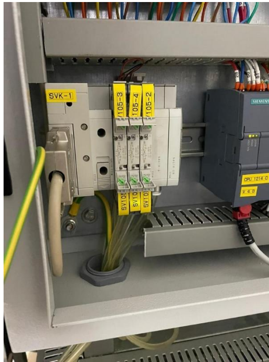
Ilustración 59 – PLC dañado en la autoclave de vapor
