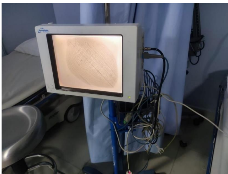
Ilustración 73 – MSV defectuoso de gastroenterología
