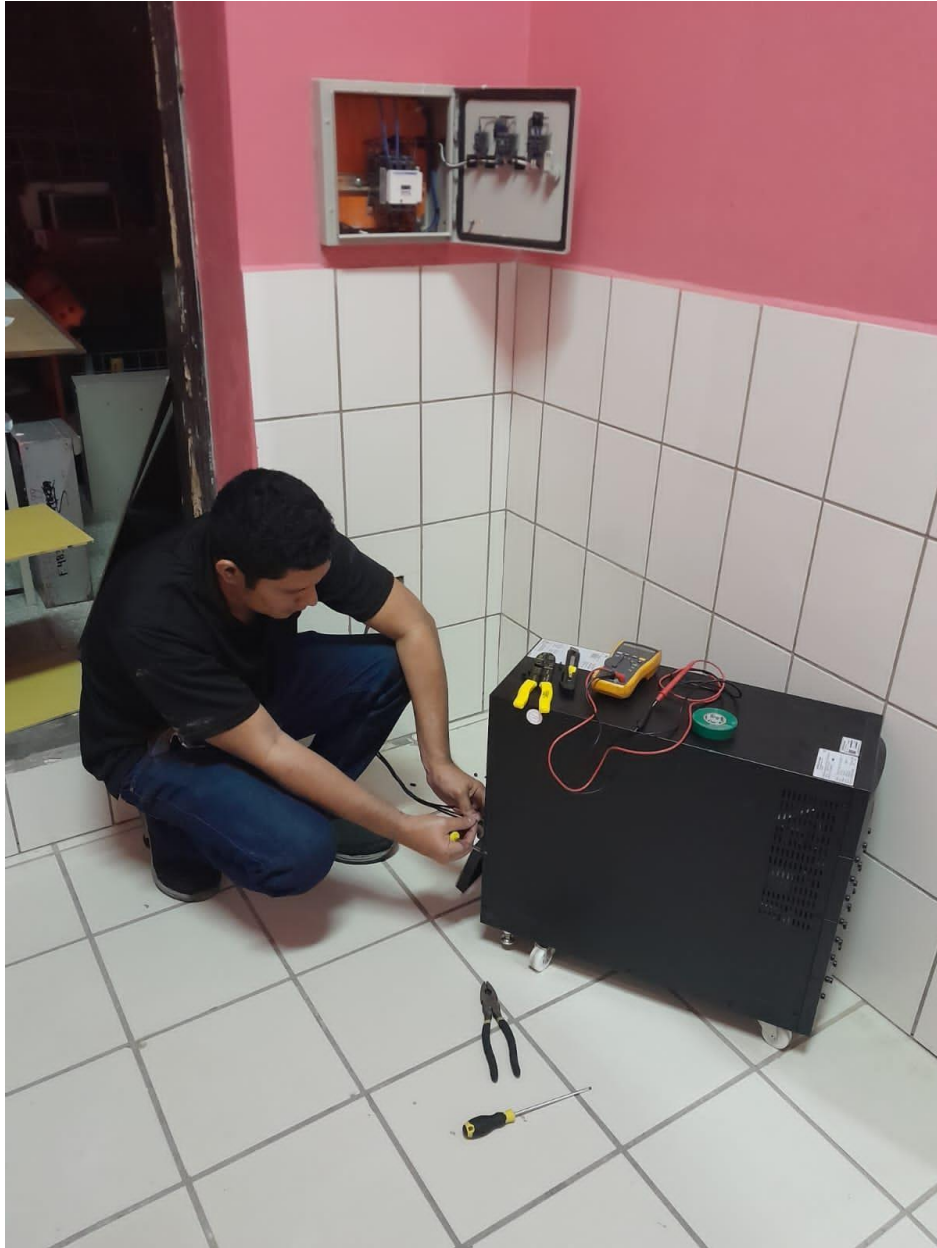
Ilustración 31- Instalación de UPS y banco de baterías para el equipo de mamógrafo.
