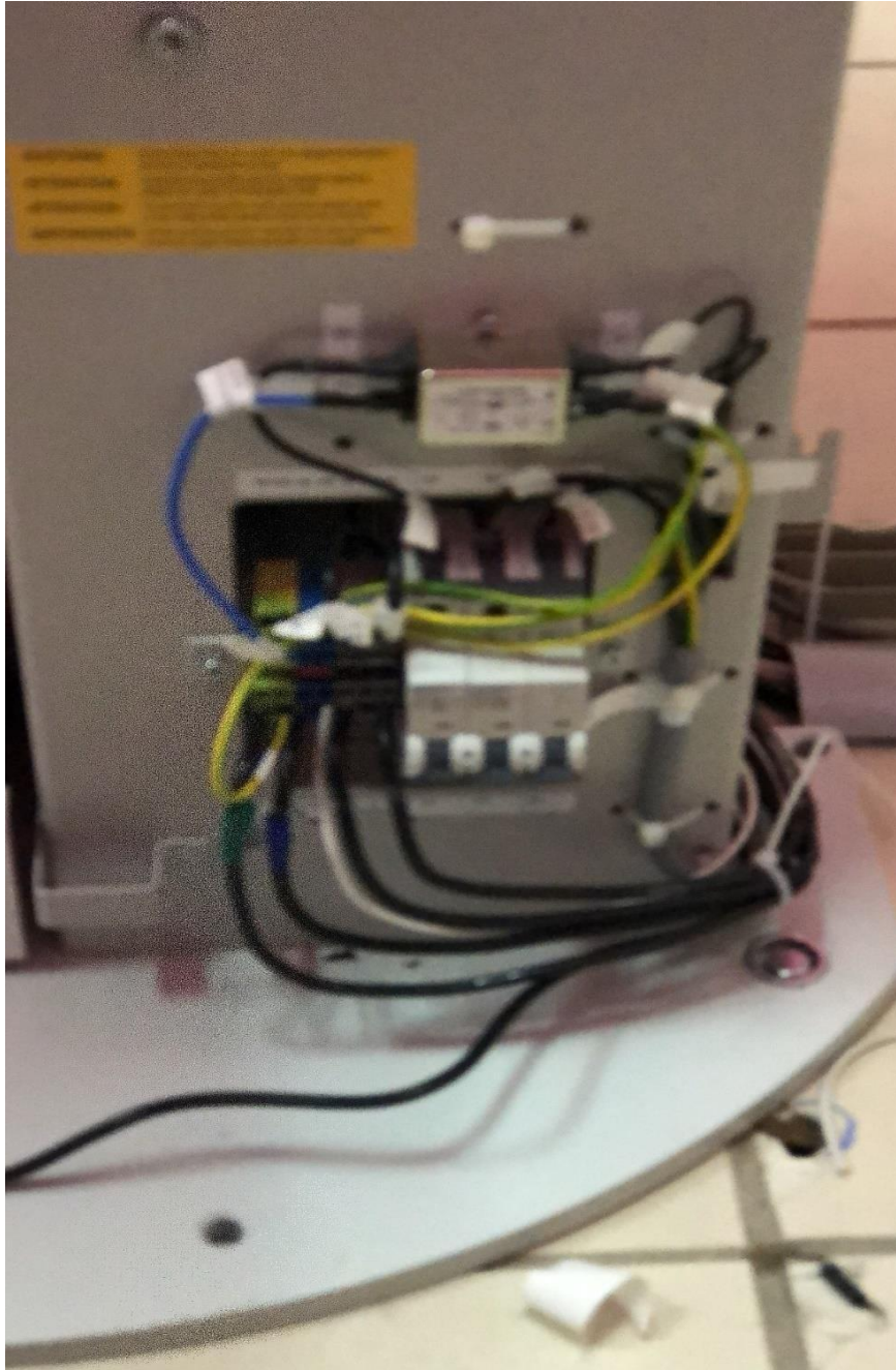
Ilustración 38- Conexión eléctrica del Mamógrafo.
