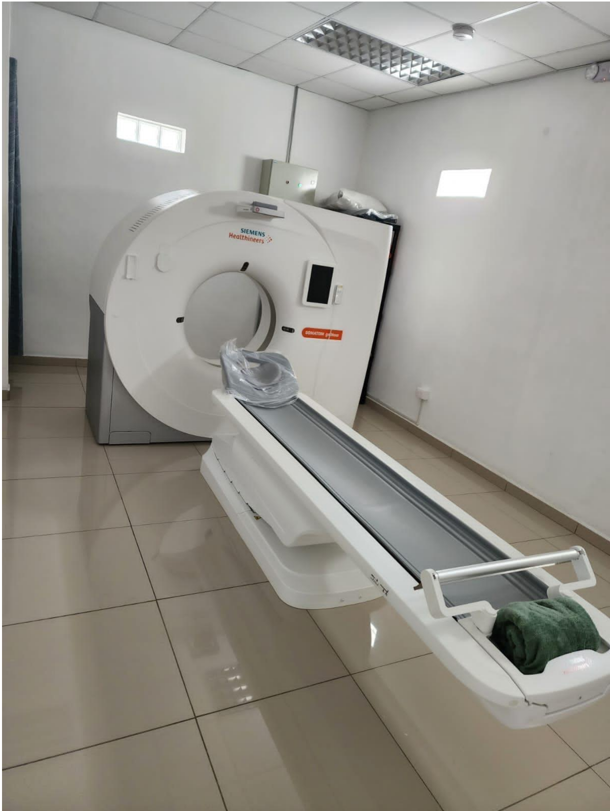
Ilustración 10- Inspección Visual General del equipo – Tomógrafo SOMATOM go
