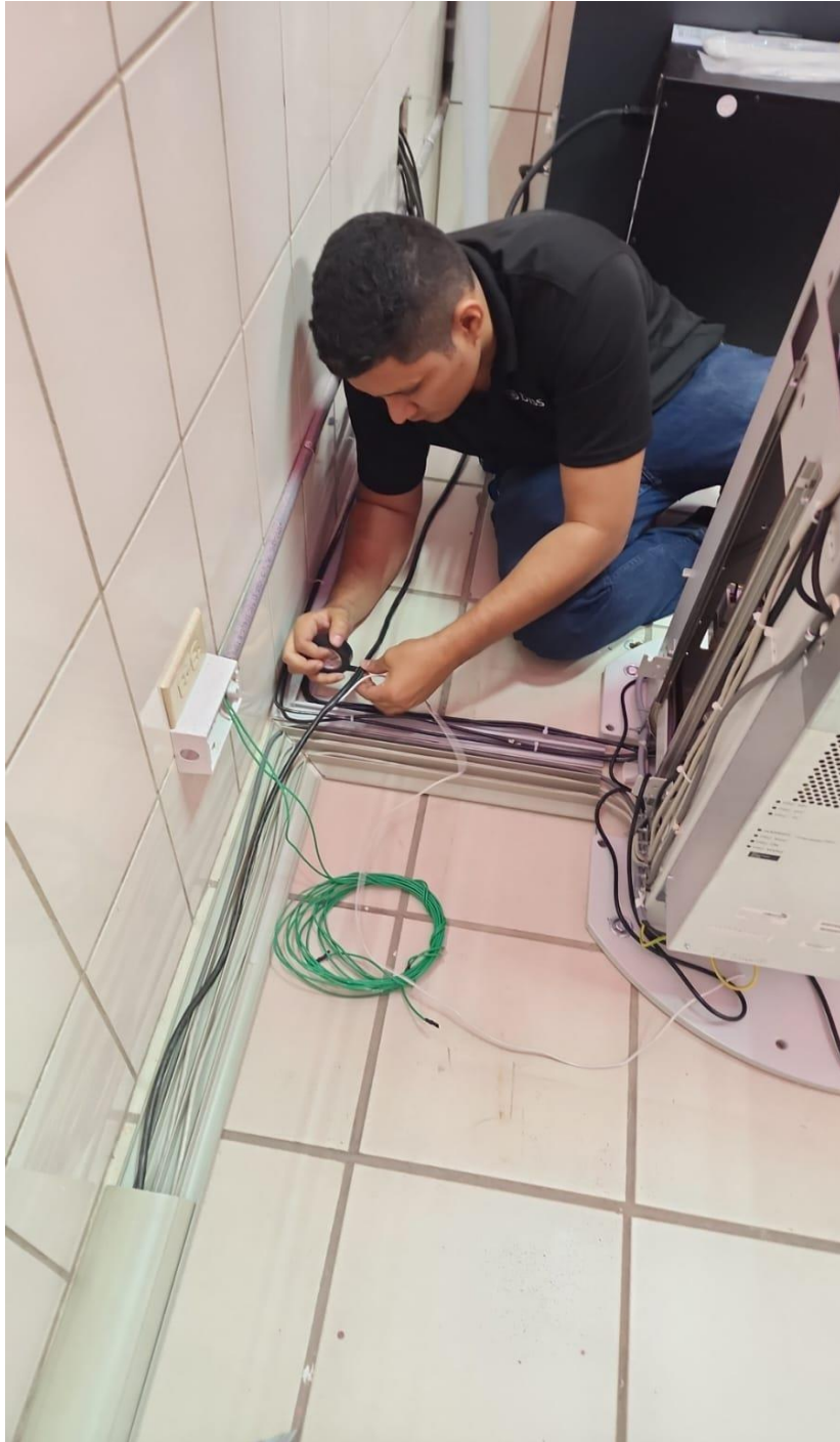
Ilustración 39- Verificación, peinado de cableado del MAMOMAT Fusion.
