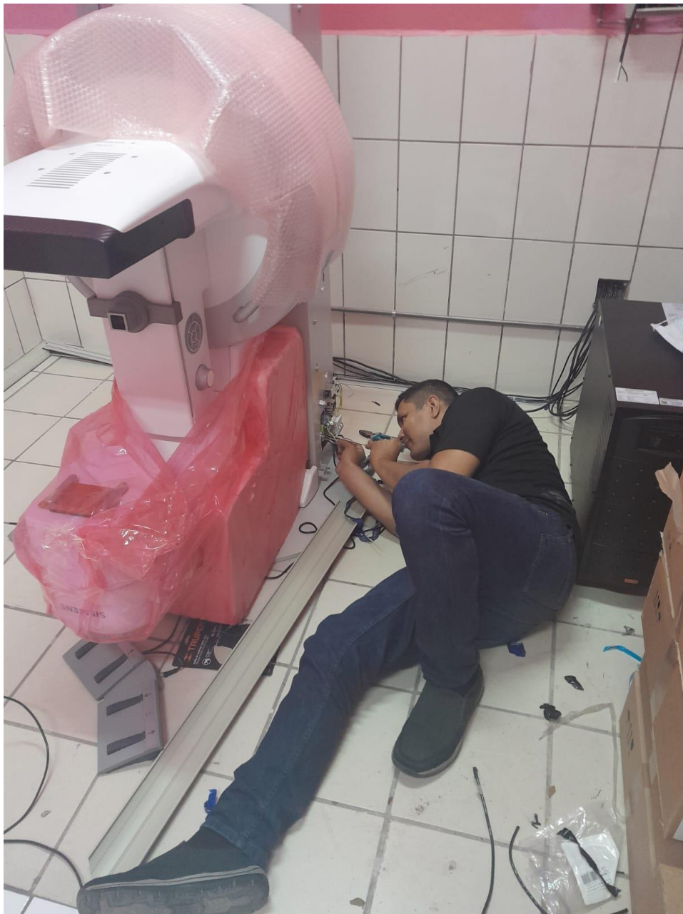
Ilustración 34- Conexión eléctrica hacia el equipo MMMOMAT Fusion.
