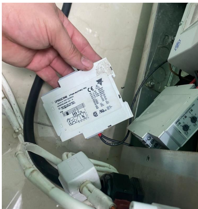
Anexo 27. Pieza cambiada del chiller del angiografo.
