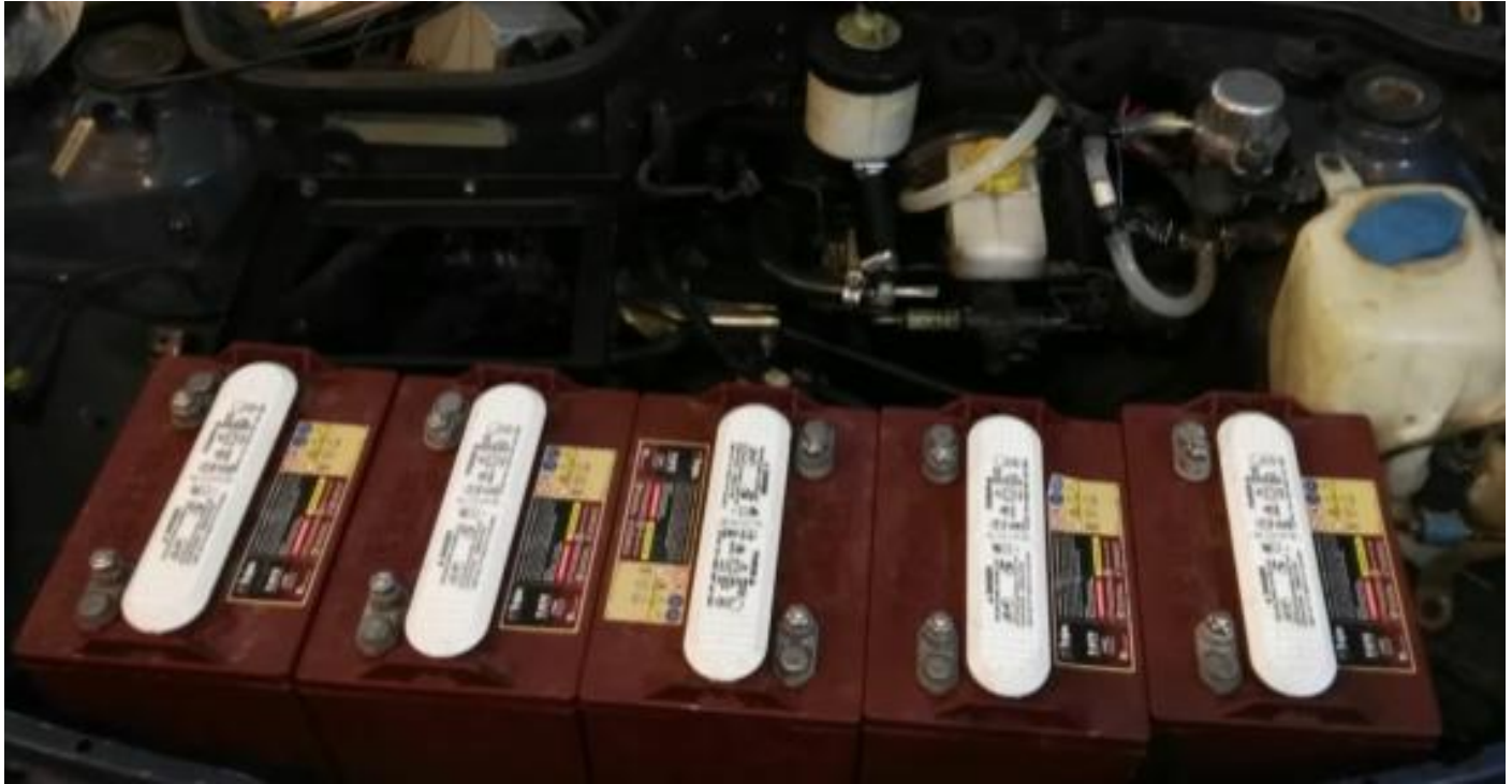
Figura 4.22: Banco de baterías instalado
