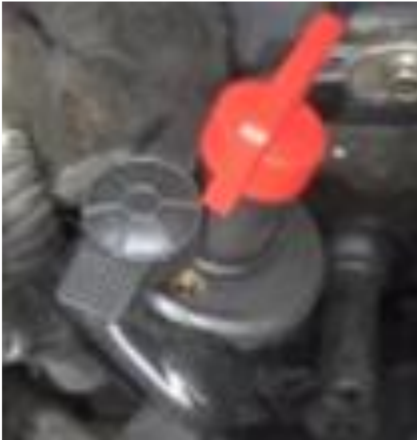
Figura 4.23: Paro de emergencia entre batería y controlador
