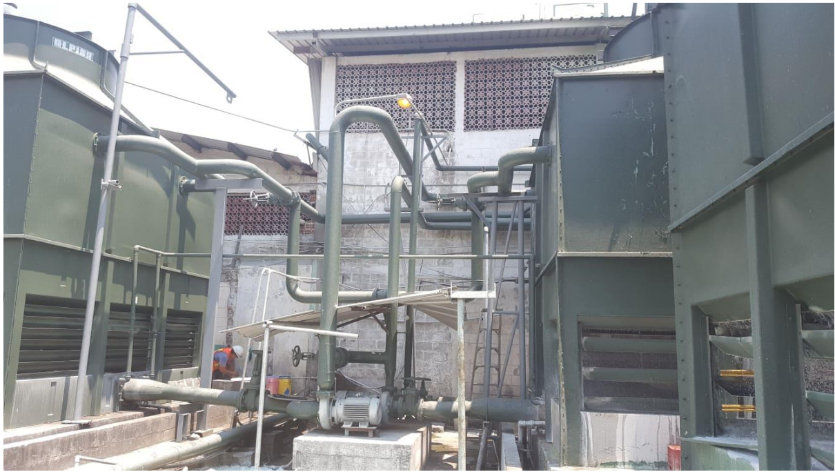
Ilustración 7. Torres de enfriamiento de área de jabón
