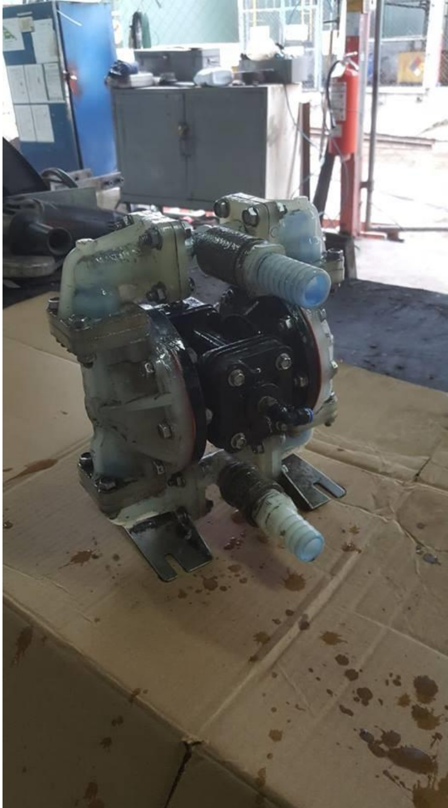
Ilustración 21. Mantenimiento de bomba neumática en área de suavizante
