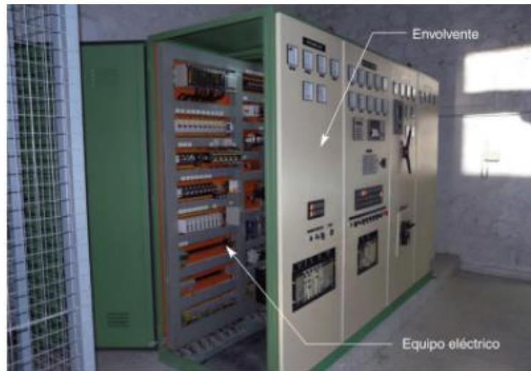
Ilustración 6. Panel de control
