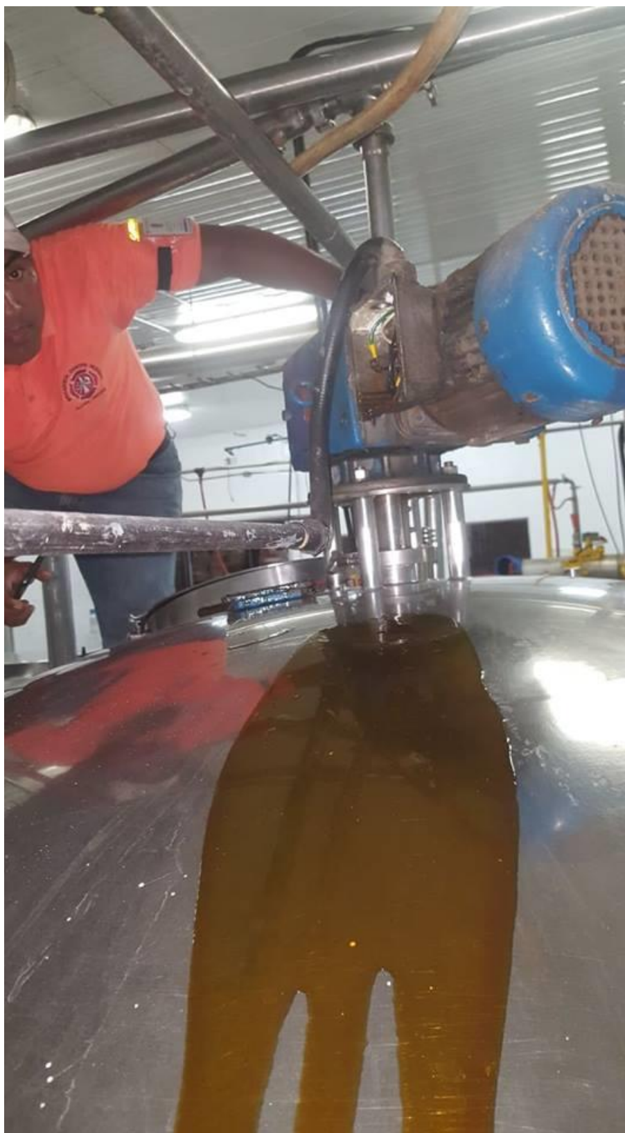
Ilustración 23. Mantenimiento de motor de Tanque de Premezcla de la sala 2 de área de margarina
