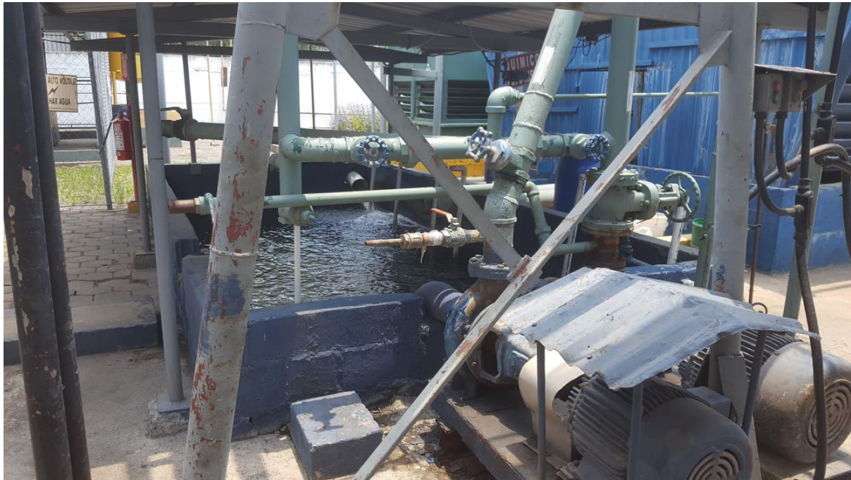
Ilustración 14. Pila de agua de Torre de enfriamiento área de margarina
