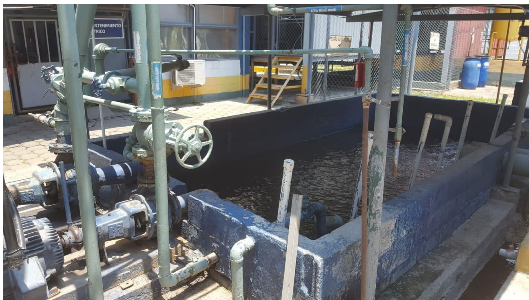
Ilustración 15. Pila de agua de Torre de enfriamiento área de margarina
